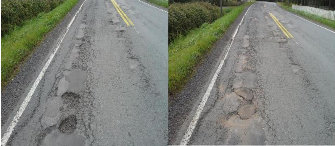
KUVA 21. Tiestöllä olevia vaurioita ennen ja jälkeen paikkauksen
