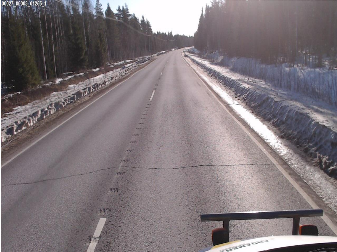
KUVA 6. Tiellä oleva poikkihalkeama
