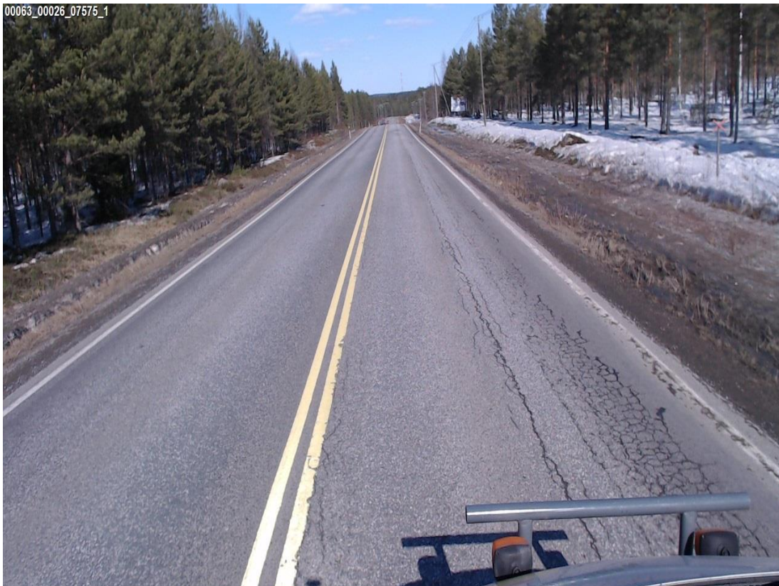
KUVA 2. Tien reunalla olevaa uraa, johon on muodostunut verkkohalkeamaa
