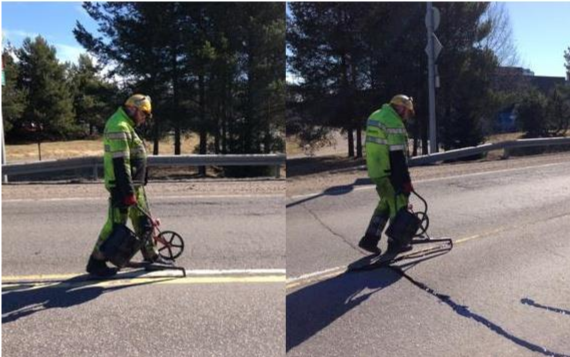
KUVA 13. AB-päällysteen halkeamien kannukaatosauhausta
