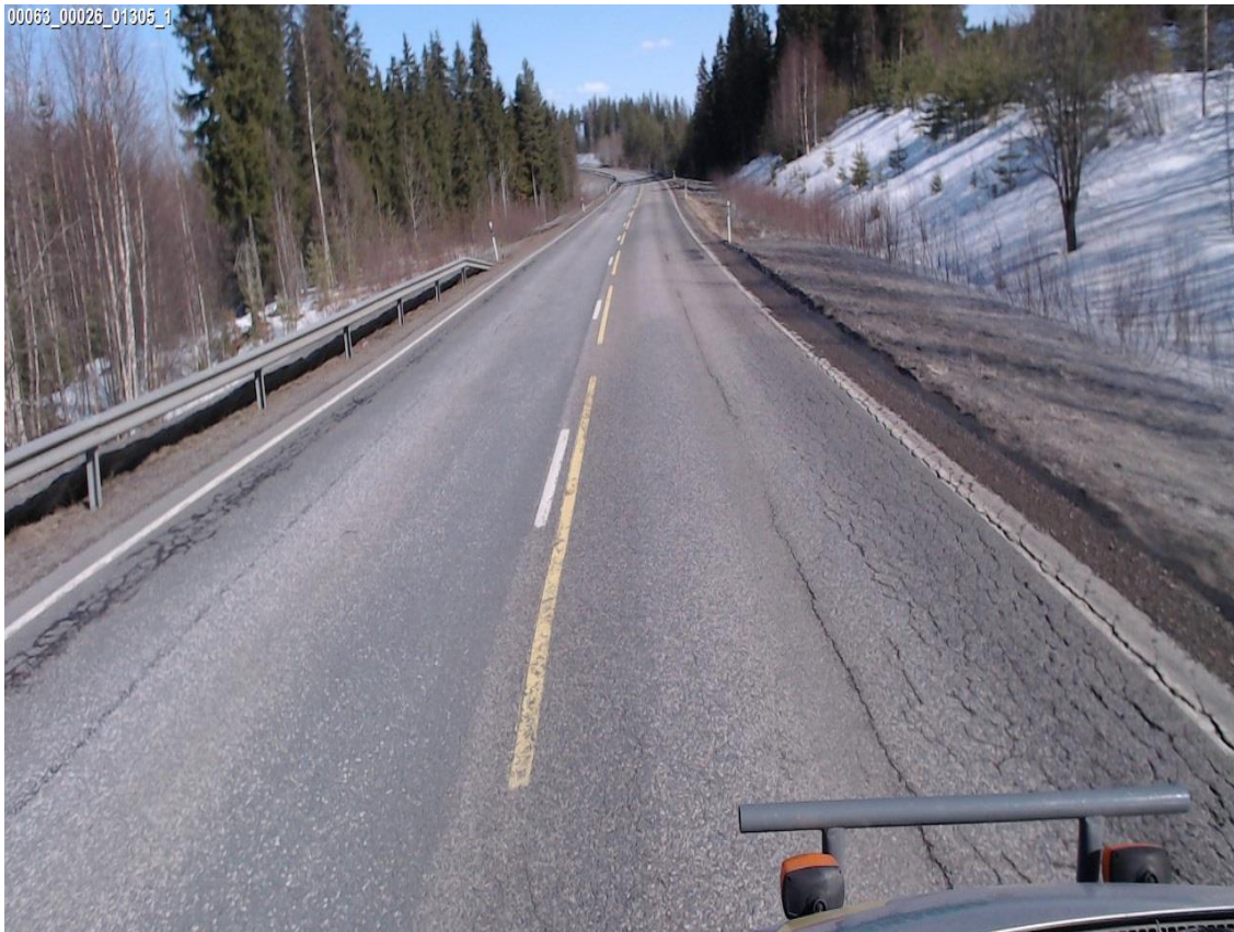
KUVA 4. Tienreunalla olevaa tiheää verkkohalkeamaa
