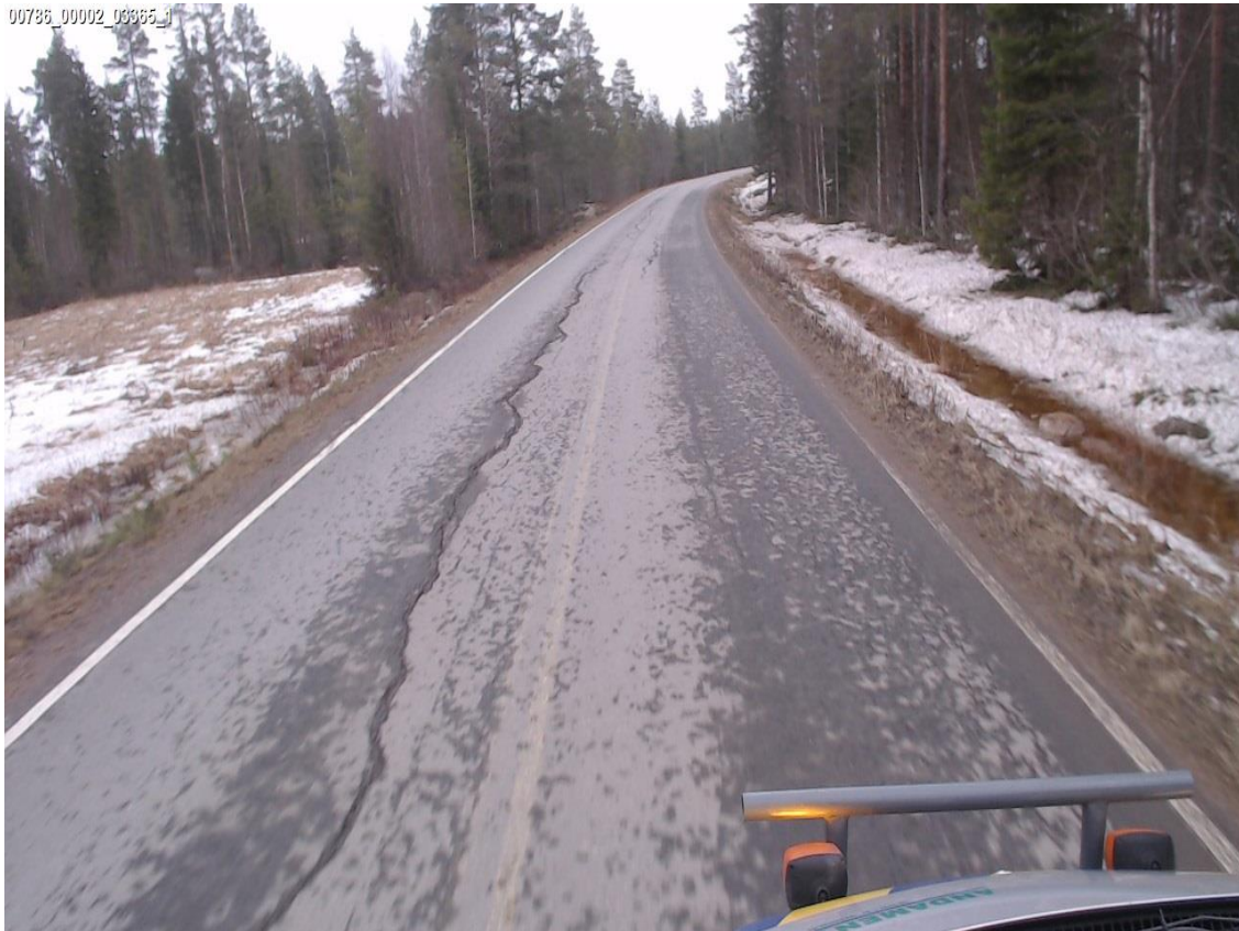
KUVA 5. Tiellä olevaa pituushalkeamaa
