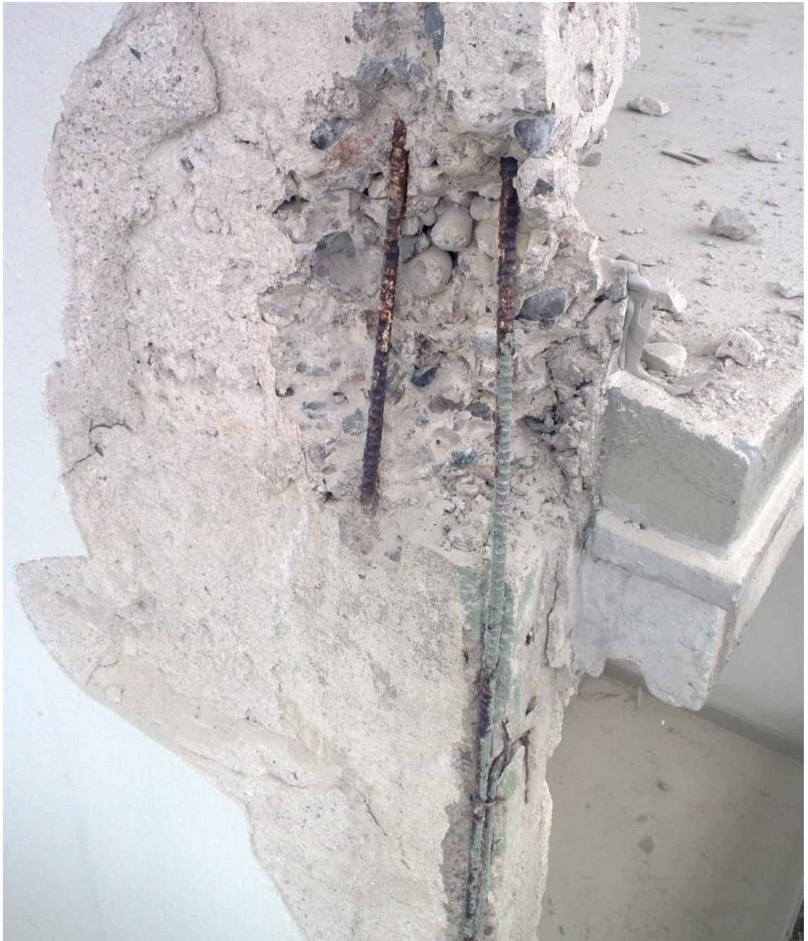
Kuva 26. Rappauksen alta paljastui pahoin vaurioituneita harjateräksiä. Nykynormien mukaan 1960-luvun raudoituksen määrä on As Oy Satomäessä kyseenalainen. Lisäksi betoni on alun perinkin ollut huonolaatuista, mahdollisesti siksi, että massa on pudotettu valettaessa liian korkealta ja kivet ovat tällöin päässeet erottumaan. Ennen rappauksen korjausta suoritettiin betonikorjaus.
