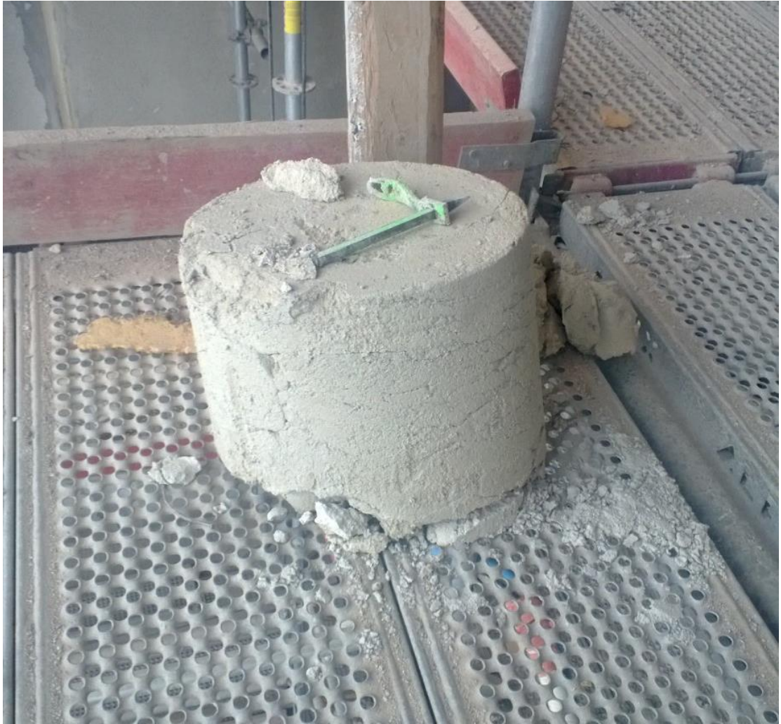
Kuva 12. Kovettunut laastiämpärin sisältö on valitettavan yleinen näky rappaustyömaalla. Oikea-aikainen siivous helpottaa työmaan saattamista valmiiksi ja säästää kustannuksia.
