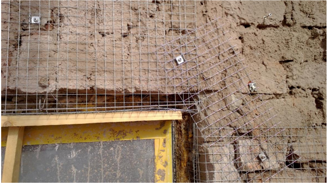
Kuva 23. Smyygin verkotus ja aukon yläpuolelle asennettu Rst-tanko. Lauta toimii muottina ensimmäisessä laastitäytössä.
