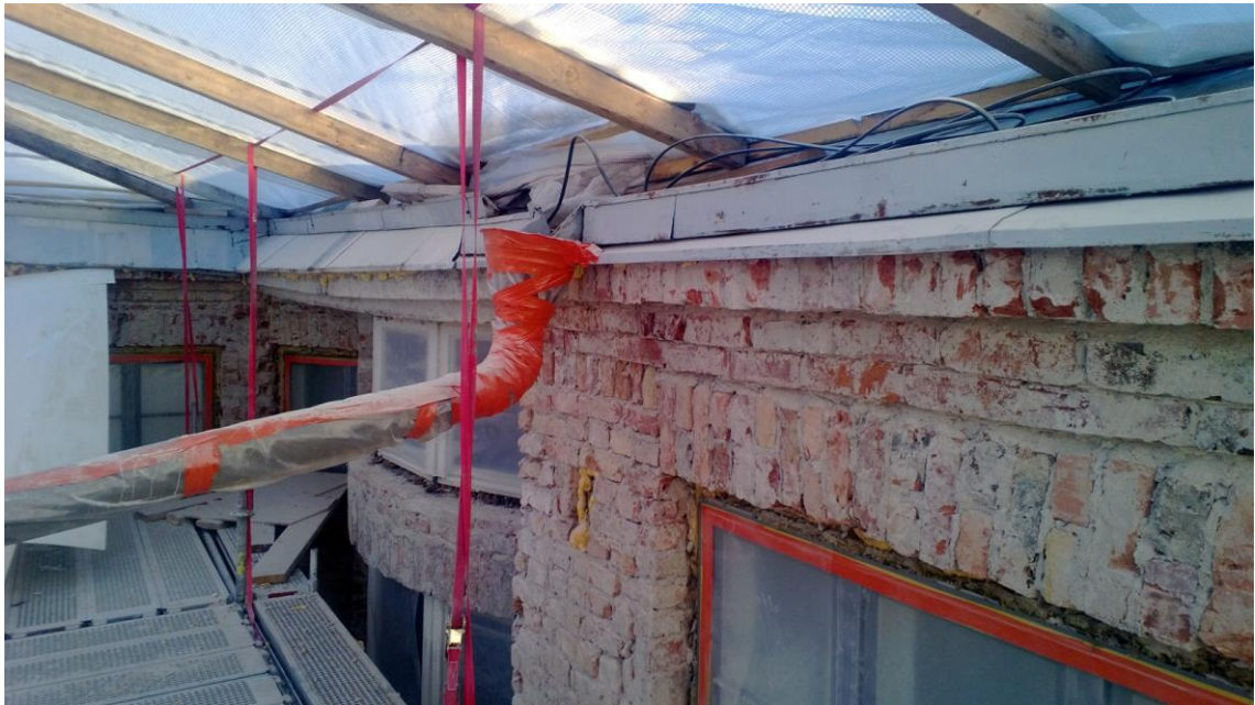
Kuva 7. Tiiliseinä vanhan rappauksen piikkauksen jälkeen ennen painepesua. Korvausilma-venttiili on tukittu villalla ja polyuretaanivaahdolla. Ikkunoiden ympäri kiertää rappasteippi, johon suojamuovi on kiinnitetty erillisellä teipillä. Kokemus on osoittanut, että muovin suora teippaaminen ikkunaan ei riitä [6].
