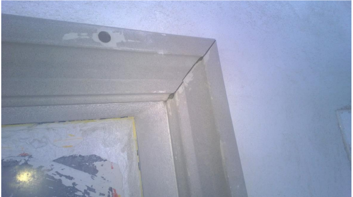
Kuva 19. Sto Decoprofil -listalla toteutettu ikkunan kehyskoriste paikalleen asennettuna. Kiinnitys tehtiin liimalaastilla ja varmistettiin mekaanisella ruuvikiinnikkeellä. Saumat viimeisteltiin vielä laastilla ennen maalausta.
