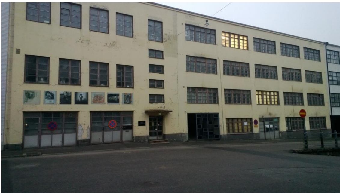
Kuva 27. Lemuntie 6 Oy Helsingin Vallilan vanhalla teollisuusalueella. Vanha rappaus on paikoin irronnut ja seinälle on jouduttu kiinnittämään rappausverkko estämään huonokuntoisimman rappausalueen laastin putoamisen ohikulkijoiden päälle. Rappaus uusitaan kokonaisuudessaan keväällä 2014.
