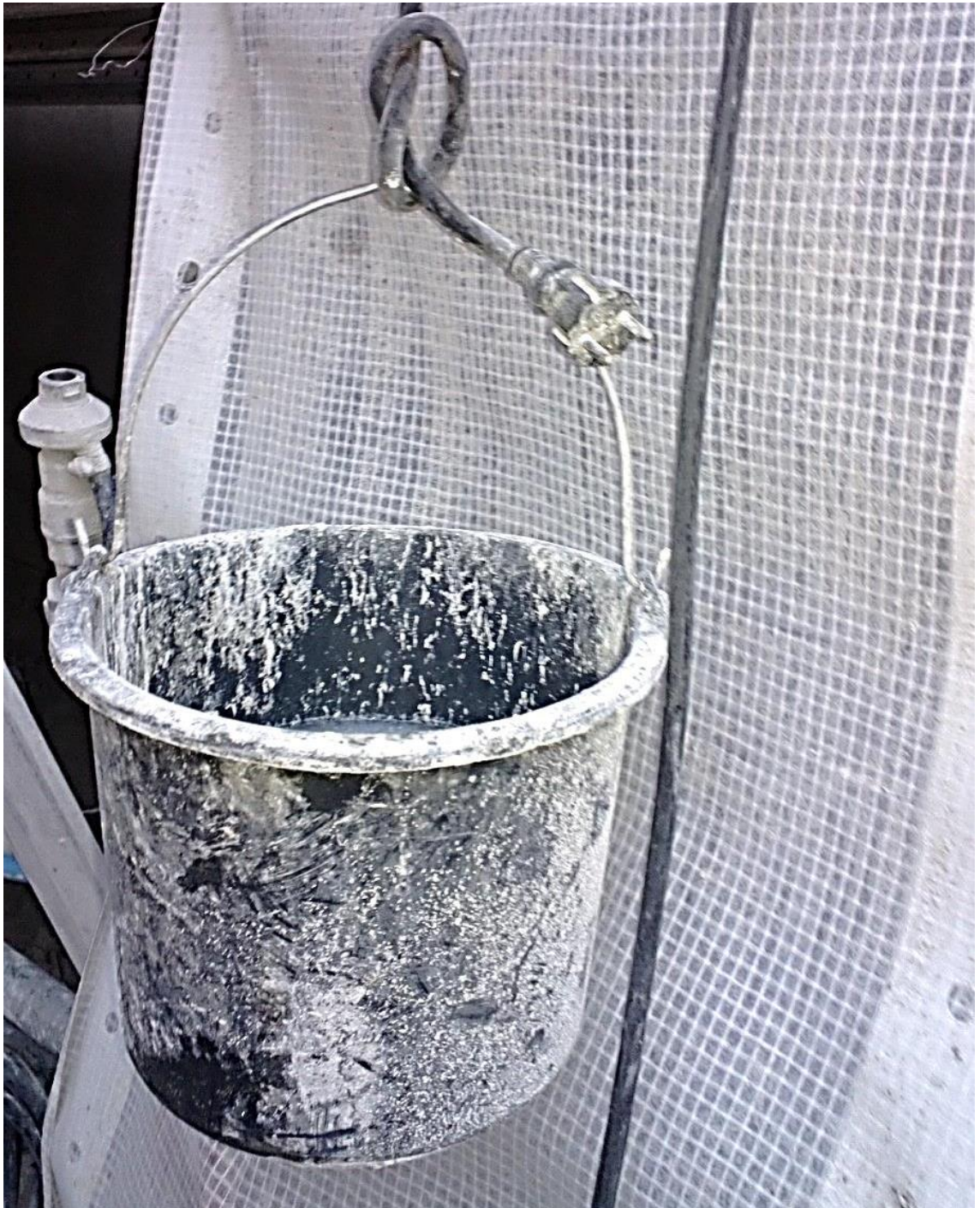
Kuva 28. Kaikki normaalit turvallisuusmääräykset pätevät myös julkisivutöissä. Sähköjohto ei ole nostotyökalu.
