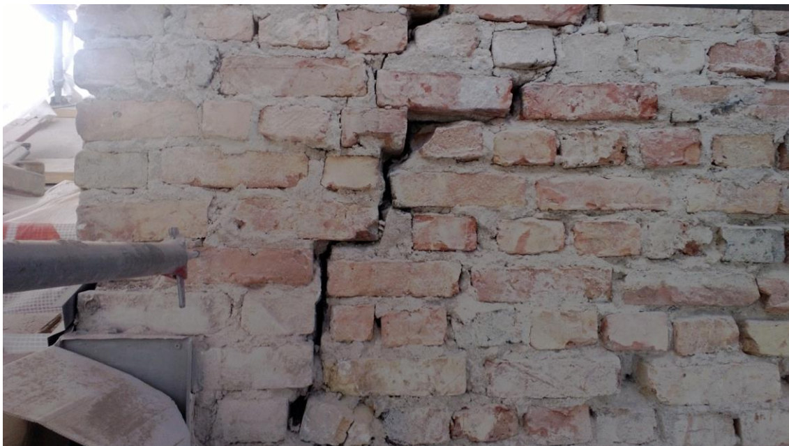
Kuva 9. Halkeamat verkotetaan yleensä aina yli. Tässä tapauksessa halkeama oli mahdollisesti aiheutunut rakennuksen liittymisestä naapuritaloon. Kuvan vasemmassa alareunassa näkyy naapuritalon vesikaton pellitystä. Halkeaman uusiutuminen uudenkin rappauksen läpi on verkotuksesta huolimatta mahdollista. Halkeama jatkui suorana alaspäin koko rakennuksen korkeudella. Tältä osin seinään sahattiin liikuntasaumaksi suora ura, johon asennettiin paisuva saumausnauha.
