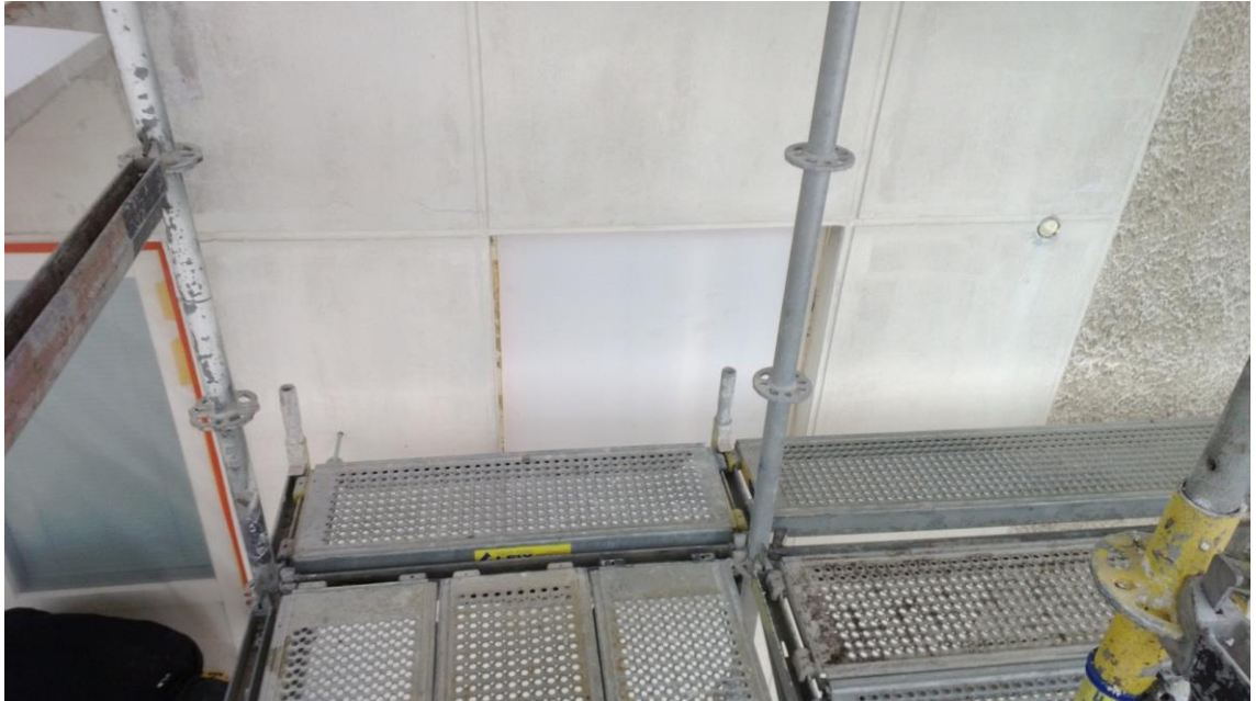
Kuva 5. Teline varustettuna irrotettavalla sisäkonsolilla, jolloin seinän viereen saadaan tarvittaessa lisää työskentelytilaa, mutta telineen ja seinän välinen aukko voidaan muuna aikana pitää riittävän kapeana putoamisen estämiseksi.
