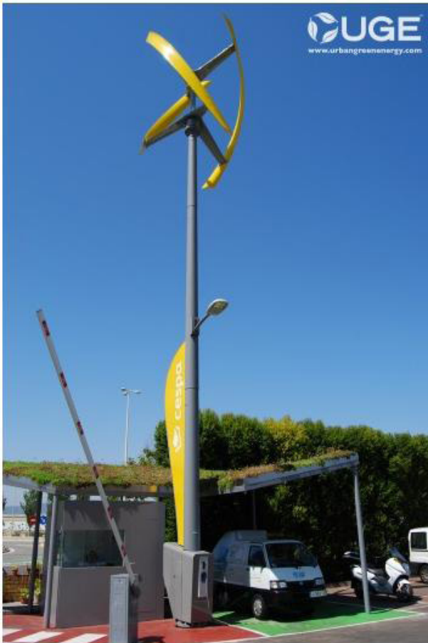
Kuva 4. Tuulivoimalla toimiva latausasema. [30].
