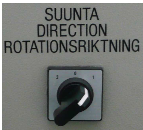
Kuva 26. Paneelin kytkin, jonka asento tulee vastata käytössä olevaa ajosuuntaa.
