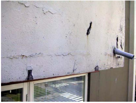
Kuva 82 Korroosion vaurioittama betoninen parvekekaide. /14/
