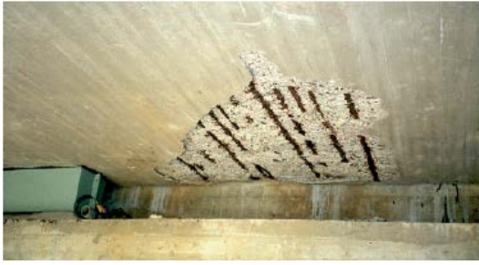
Kuva 115 Teräskorroosio on irrottanut betonipeitteen /30/
