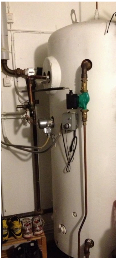
KUVIO 1. Kohteen lämminvesivaraaja
