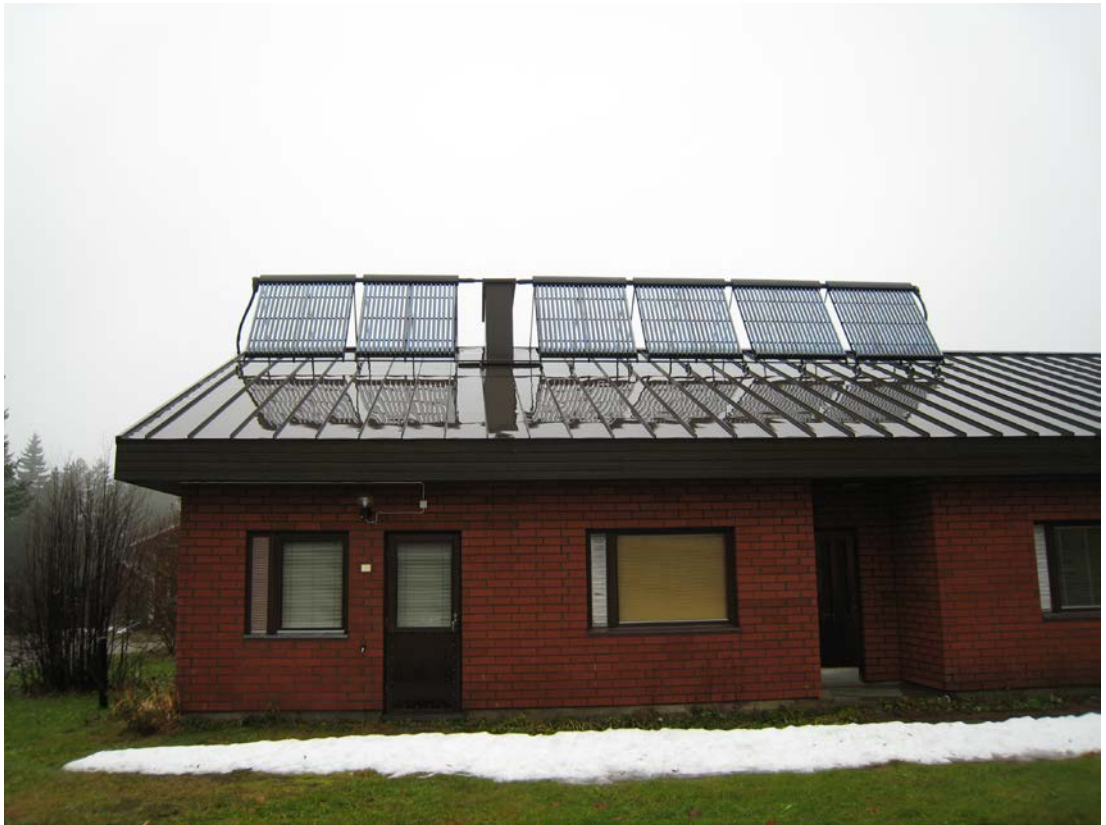
Kuvio 7. Aurinkokeräimet asennettuna
