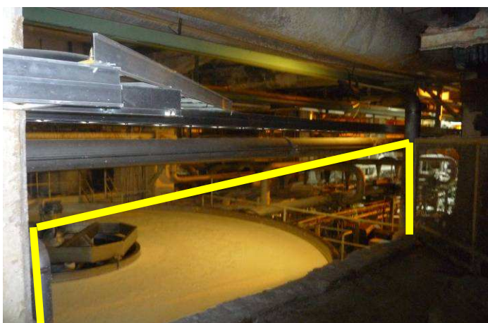
Kuvio 9. Puuttuva kaide. Alue, mistä kaiteet puuttuvat, on merkitty kuvaan keltaisin viivoin. Kuva on otettu PK 5:n massaosastolta.
