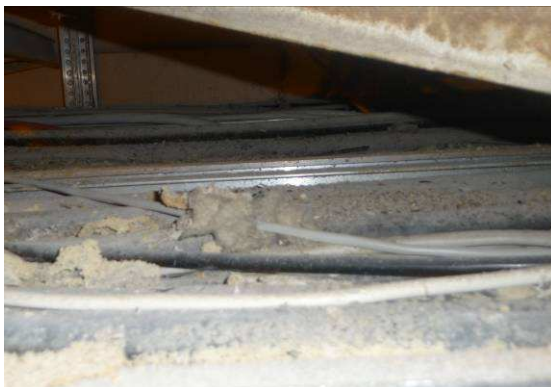
Kuvio 3. PK 5:n sivustalla olevan kaapelihyllyn pölykertymä.
