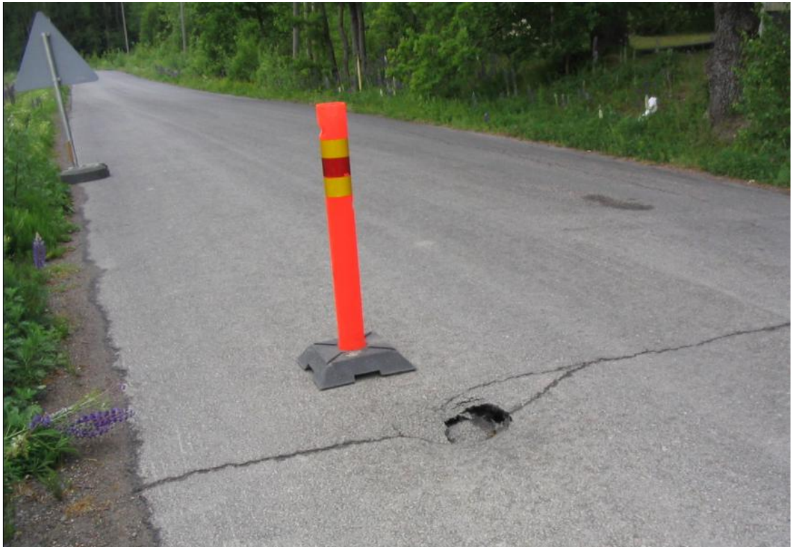
Kuva 17. Reikä ja poikittaishalkeama päällysteen pinnassa.
