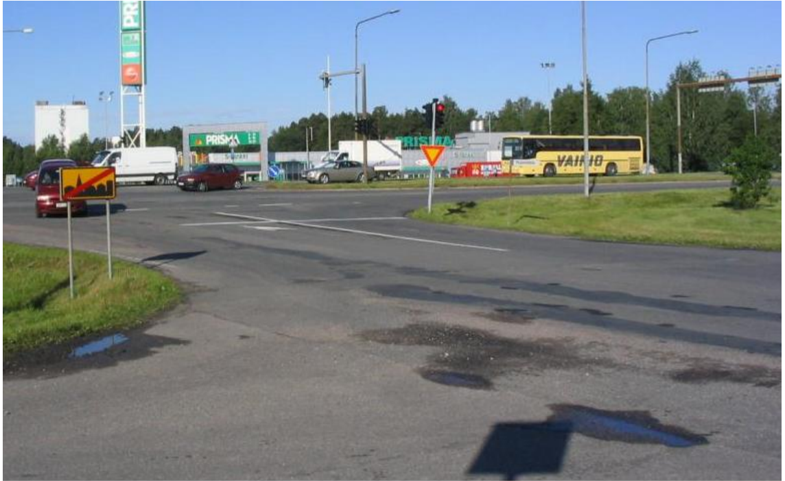
Kuva 10. Lammikoituminen kadulla ilman kaltevuuksia.
