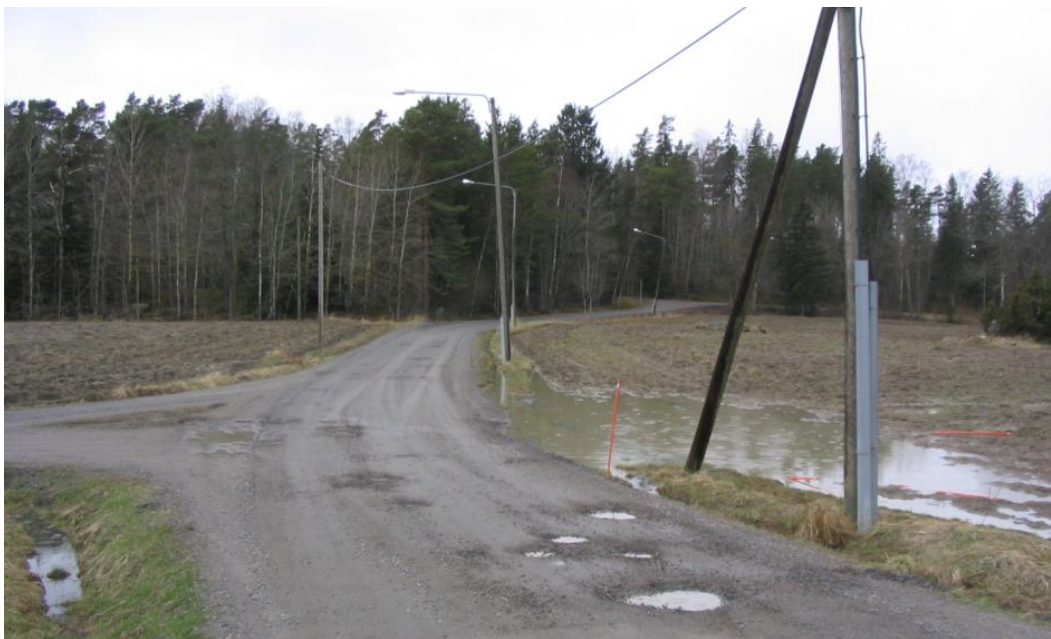
Kuva 12. Lammikoituminen avo-ojassa ja soratiellä.
