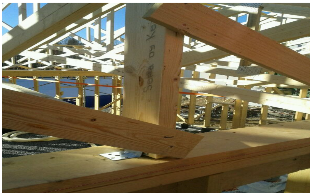
KUVA 11. Väärin asennettu kattotuoli (Fomin 2014)
