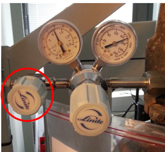
Kuva 12. Älä koske oikeanpuoleiseen säätöventtiiliin.
