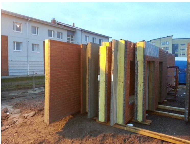
Kuva 14. Elementtifakkiin varastoituja elementtejä odottamasta suojausta
