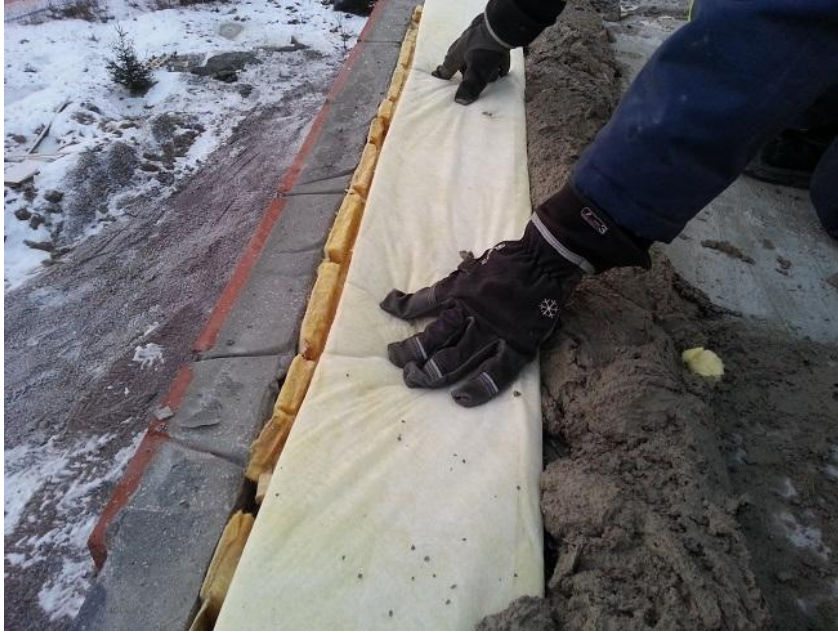
Kuva 16. Elementin yläpää valmiina seuraavan elementin asennukselle. Tuuletusurien avoimuus varmistetaan oikealla villakaistan sijoittelulla.
