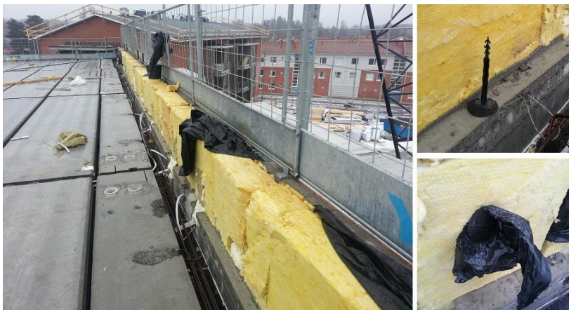
Kuva 18. Ylimpien seinäelementtien suojaus kuljetuksen jälkeen. muovin alalaidan kiinnikkeinä käytetyt muovinastat eivät kovassa tuulessa ja ajoviimassa pidä muovia paikallaan.
