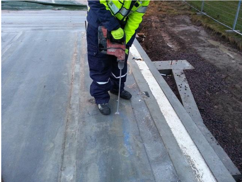
Kuva 20. Ontelolaatan rei'itys. Alapohjan ontelot porattiin yläpuolelta läpi, väli- ja yläpohjat alapuolelta onteloon.
