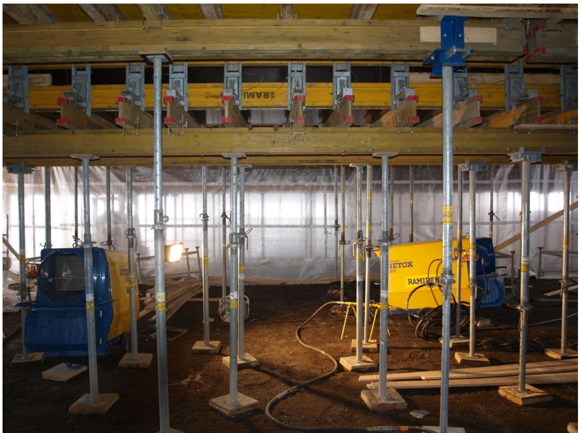
Kuva 2. Holvin alapuolisen tilan suojaukset ja lämmittimet.
