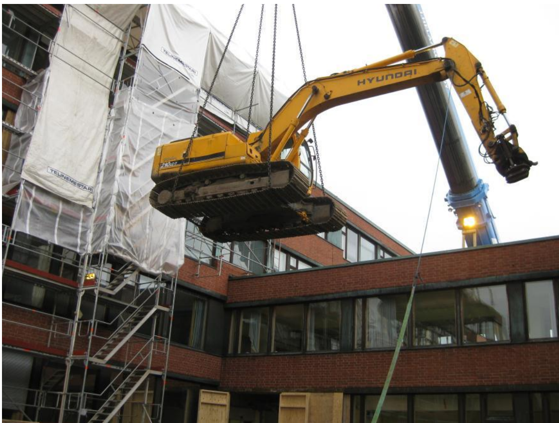
Kuva 9. Kaivinkoneen siirto suljetulle sisäpihalle, maankaivuutöitä varten. Taustalla julkisivu huputettuna ikkuna- ja julkisivukunnostusta varten. [9]
