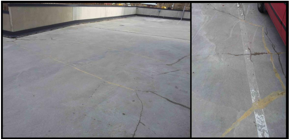
Kuva 37. Vasemman puoleinen kuva on halkeamasta 3 ja oikean puoleinen halkeamasta 2. Kuvat: Ville Sikanen.
