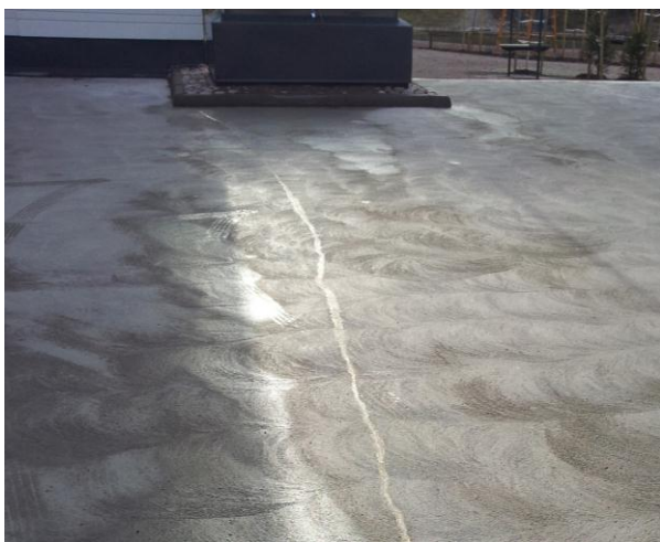
Kuva 39. Kuva halkeamasta 6. Halkeama on lähtenyt liikkeelle kuvan ylälaidassa näkyvän savunpoistoluukun juuresta ja edennyt koko kentän halki. Kuva: Ville Sikanen.
