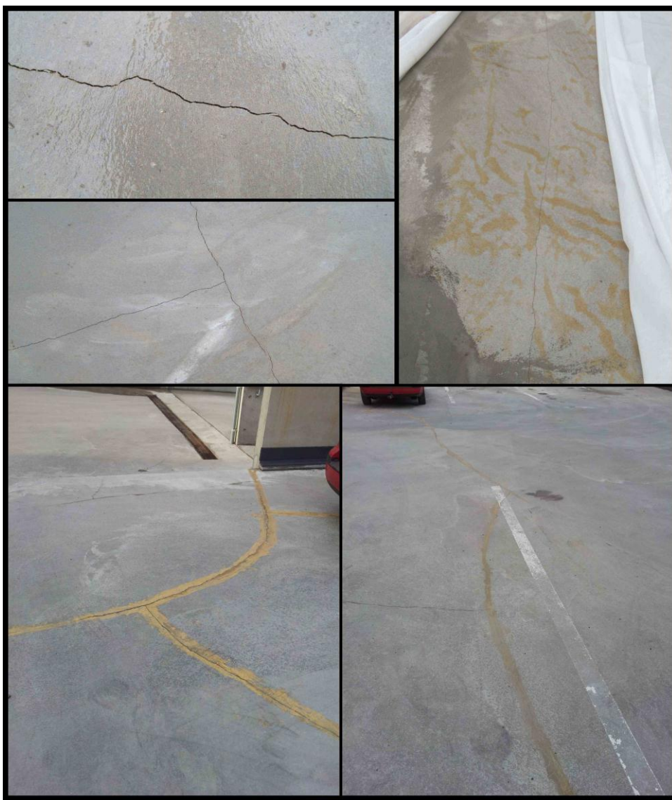
Kuva 40. Kuvia halkeamakartan halkeamasta 4. Kuvat: Ville Sikanen.
