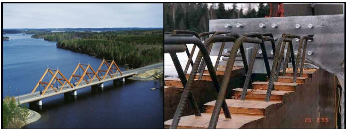
Kuva 5. Yleiskuva vihantasalmen puusillasta vasemmalla ja oikealla liimapuupalkin ja kannen teräsvaarnat ja loveukset ennen kansivalua [7; 8].
