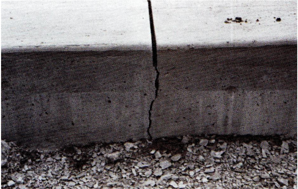
Kuva 21. Sahasauman kohdalta haljennut lattia [24].
