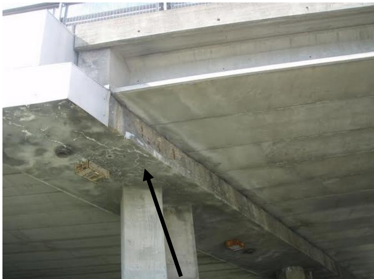
KUVA 17. Jbe I:n alusrakenteen vaurioita vuotavien saumojen takia (Jorma Lampinen Huura Oy, 2013)
