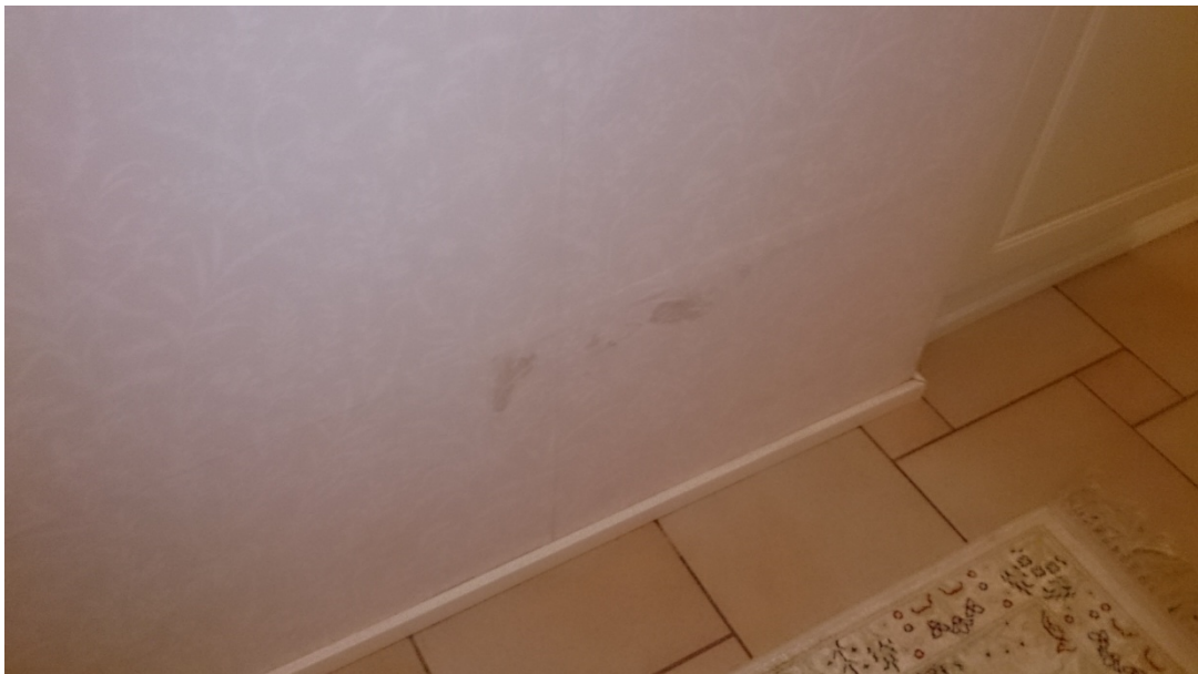
KUVA 5. Kostunut ja kupruileva tapetti käytävällä
