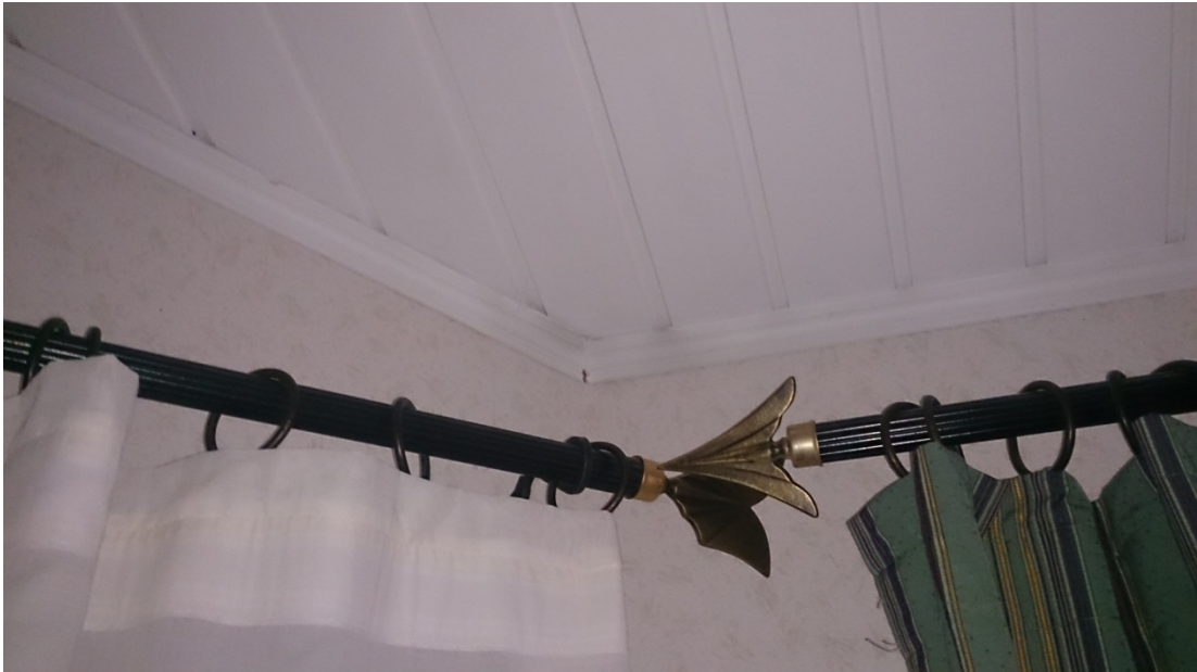
KUVA 4. Mahdollinen ilmanvuotokohta olohuoneessa
