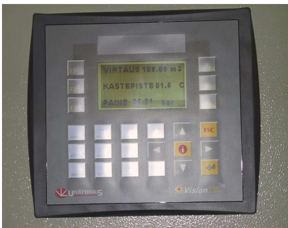
Kuva 8. Mittausyksikkö Unitronics® Vision230™ PLC.
