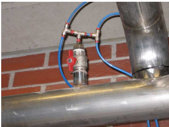
Kuva 25. Paineilmaverkoston pääputki, sekä paineen- ja kastepisteen mittausletkut.
