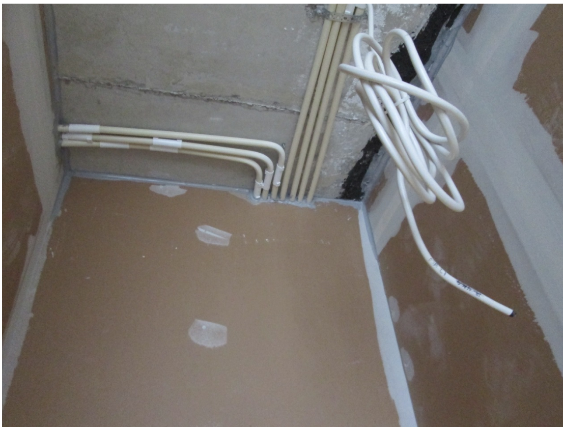
KUVA 7. Sähköputkituksen läpivienti ei osastoivassa väliseinässä. Kuva Matti Toppi
