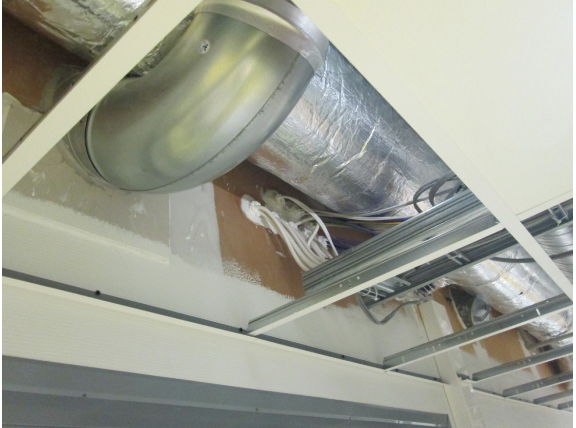
KUVA 8. Sähköjohtojen läpivienti, palo-osastonraja. Kuva Matti Toppi
