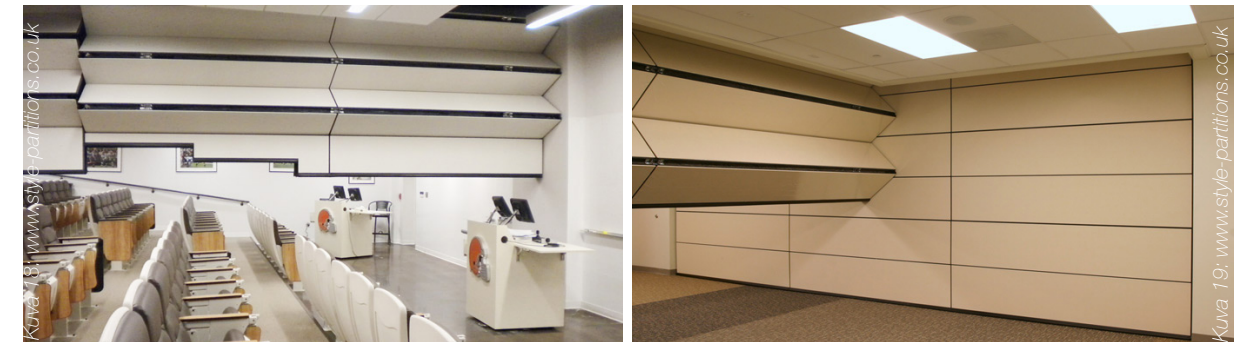
Katosta laskeutuva jakoseinä säilötään vetämässä se katon sisään. Etuna on lattiapinta-alan säästö ja soveltuvuus myös muihin kuin tasalattiaisiin tiloihin. Seinää operoidaan automaattisesti. Kuvassa Skyfoldin Powerlift-seinä.
