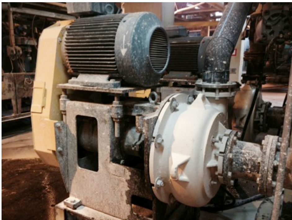
KUVA 4. Yaran kaivoksen käyttämä Serlachius -keskipakopumppu (Tiilikainen 2014.)
