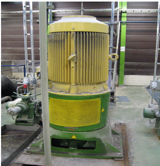
Kuva 14. Blokki 4:n merivesipumppu 5
