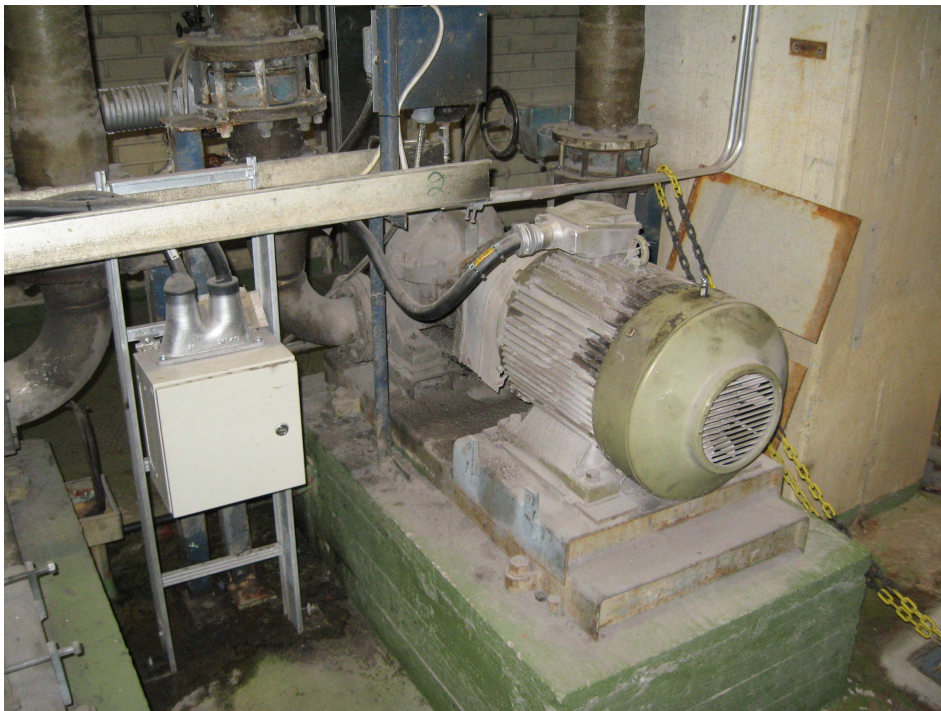
Kuva 21. Blokki 3 jäähdytysveden nostopumppu 2
