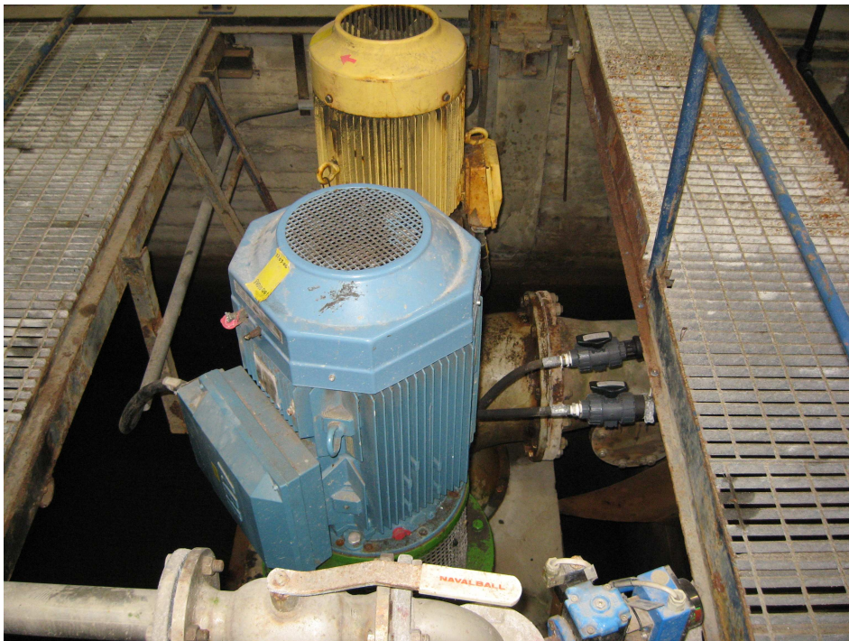
Kuva 1. Blokki 3:n välppäpumput 1 ja 2
