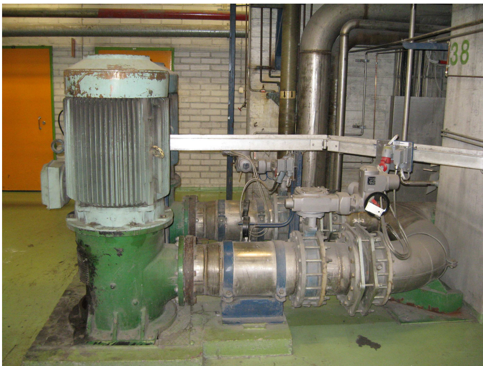
Kuva 18. Blokki 3:n jäähdytysvedenkiertopumput
