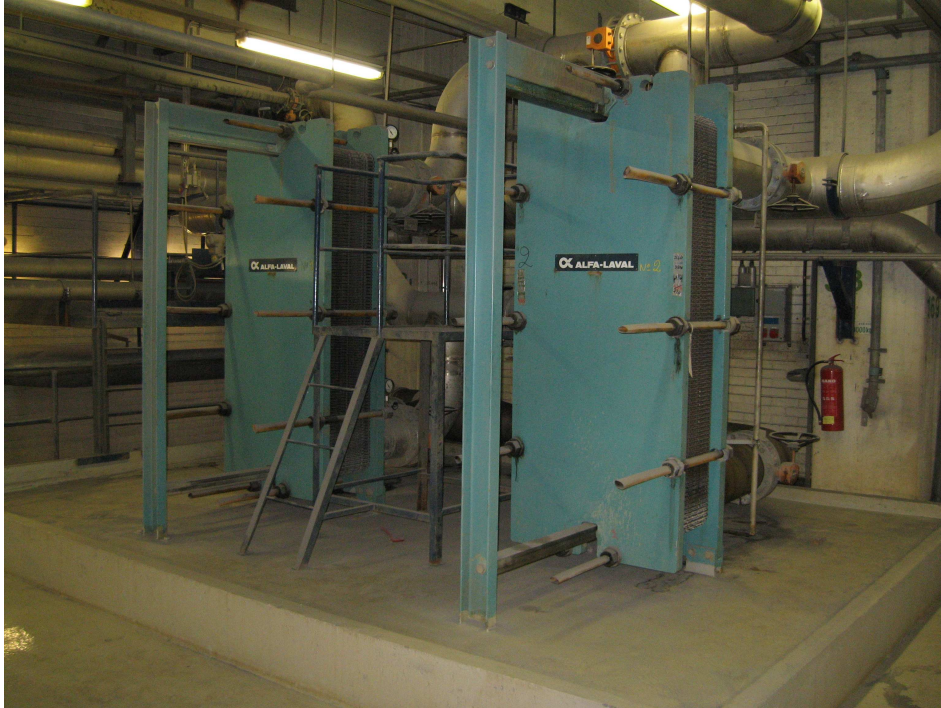
Kuva 15. Blokki 4:n levylämmönvaihtimet (Alfa Laval Nordic Oy)
