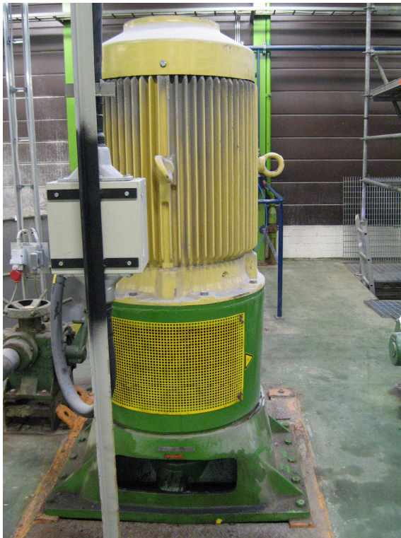
Kuva 13. Blokki 4:n merivesipumppu 4
