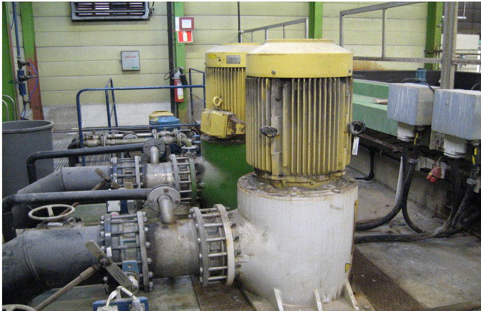
Kuva 4. Blokki 3:n merivesipumput 1 ja 2
