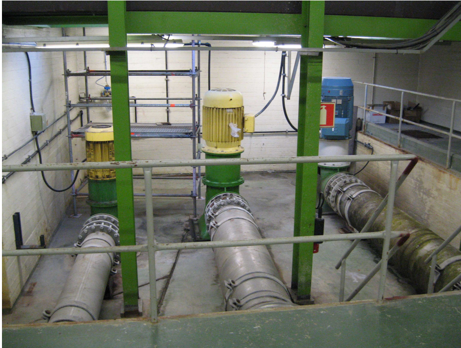
Kuva 8. Blokki 4:n välppäpumput (3, 4 ja 5)
