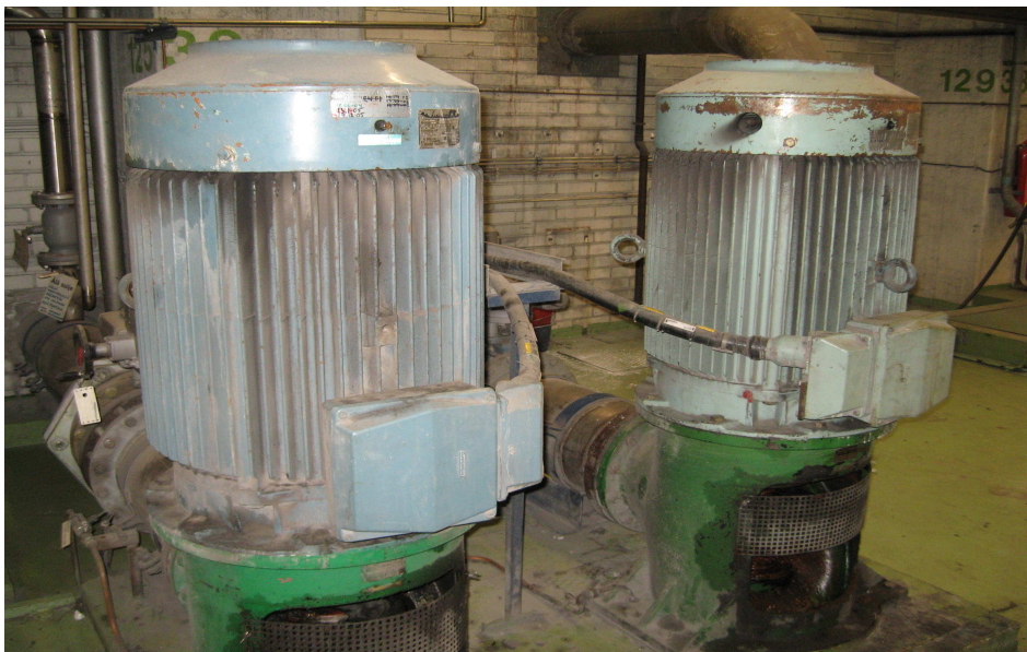
Kuva 19. Blokki 4:n jäähdytysvedenkiertopumput
