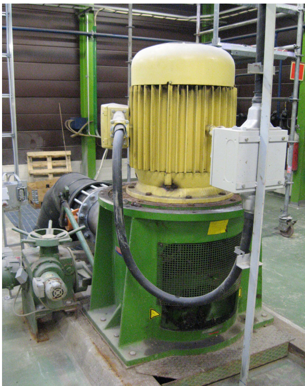
Kuva 12. Blokki 4:n merivesipumppu 3
