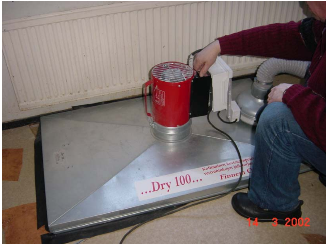
Kuva 18. Kosteusvaurion kuivatuksessa käytetty infrapunakuivain.
