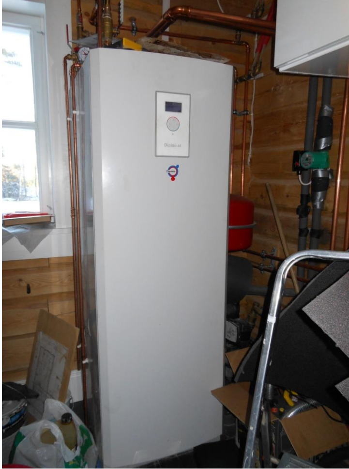
Kuva 12. Maalämpöpumppu Thermia Diplomat
