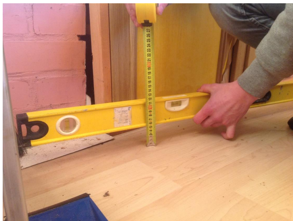
Kuva 12. Päärakennuksen lattian painuminen keittiössä.
