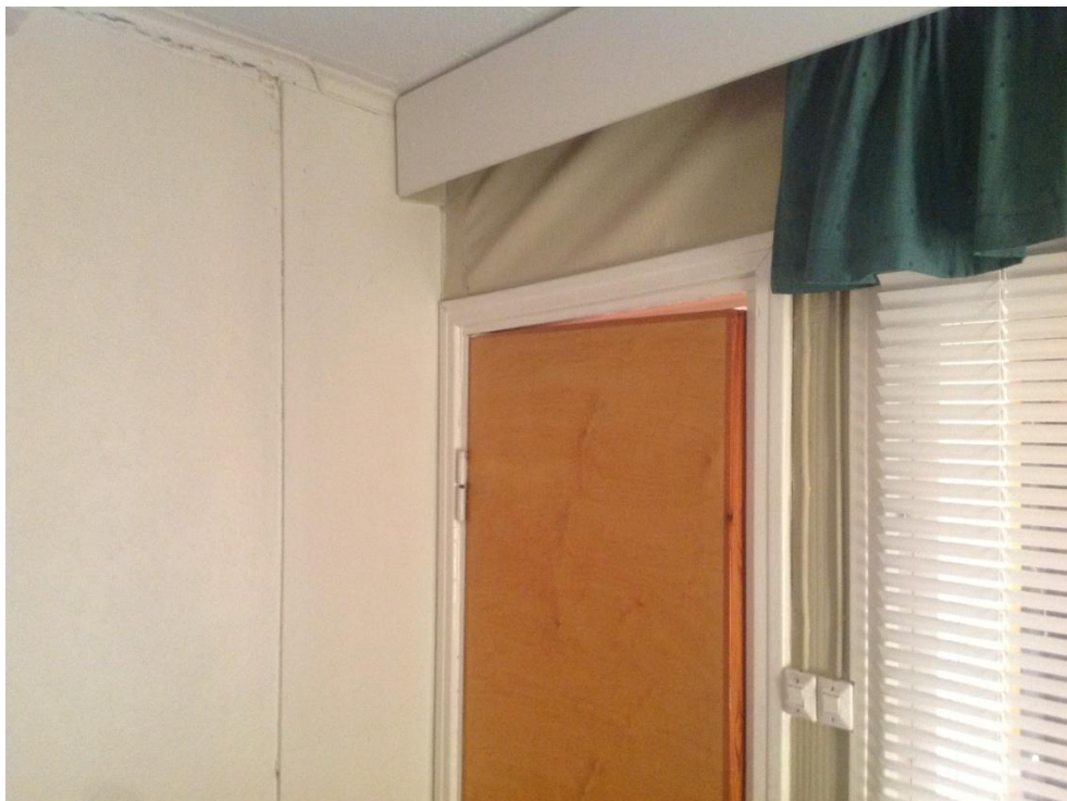
Kuva 13. Päärakennuksen olohuoneen ja eteisen välinen ovi, sekä vaurioitunut tapetti.
