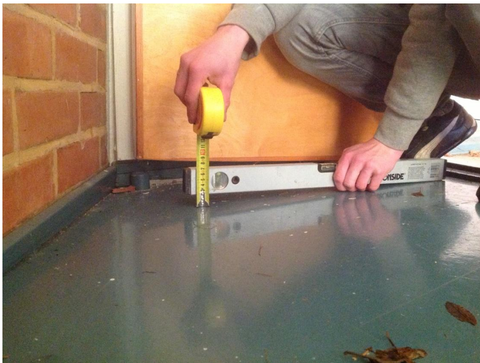
Kuva 11. Päärakennuksen lattian painuminen eteisestä olohuoneeseen.
