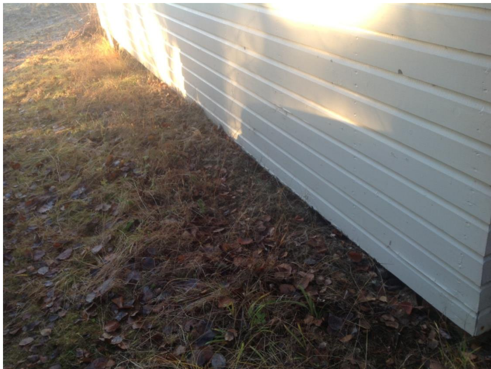
Kuva 5. Päärakennuksen alapohja ei pääse tuulettumaan riittävästi.
