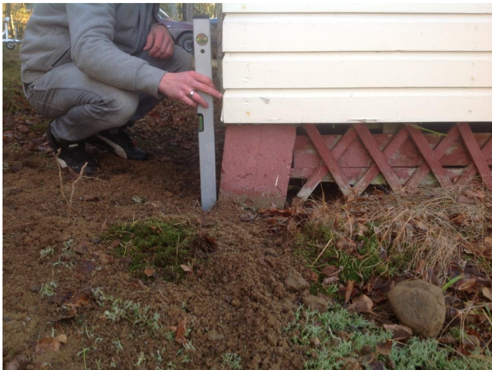
Kuva 3. Pilari kallistunut voimakkaasti.
