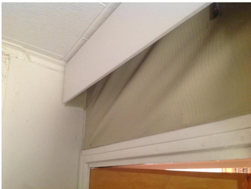
Kuva 14. Seinän tapetointi kupruillut painumisen johdosta.
