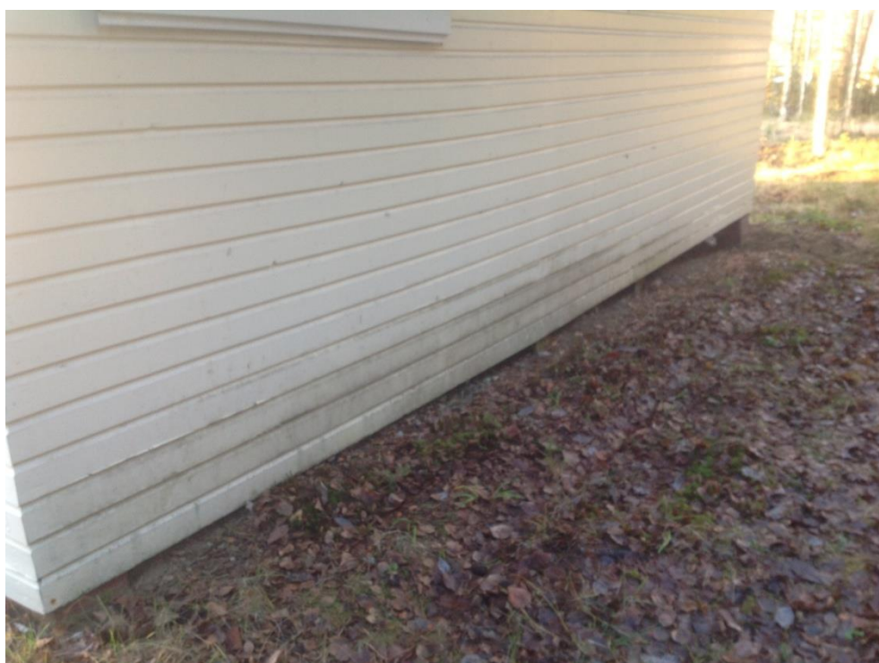
Kuva 6. Päärakennuksen alapohja ei pääse tuulettumaan riittävästi.
