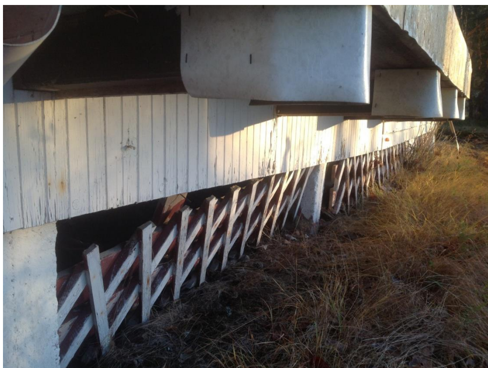
Kuva 4. Pilaririvistö on kauttaaltaan kallistunut.
