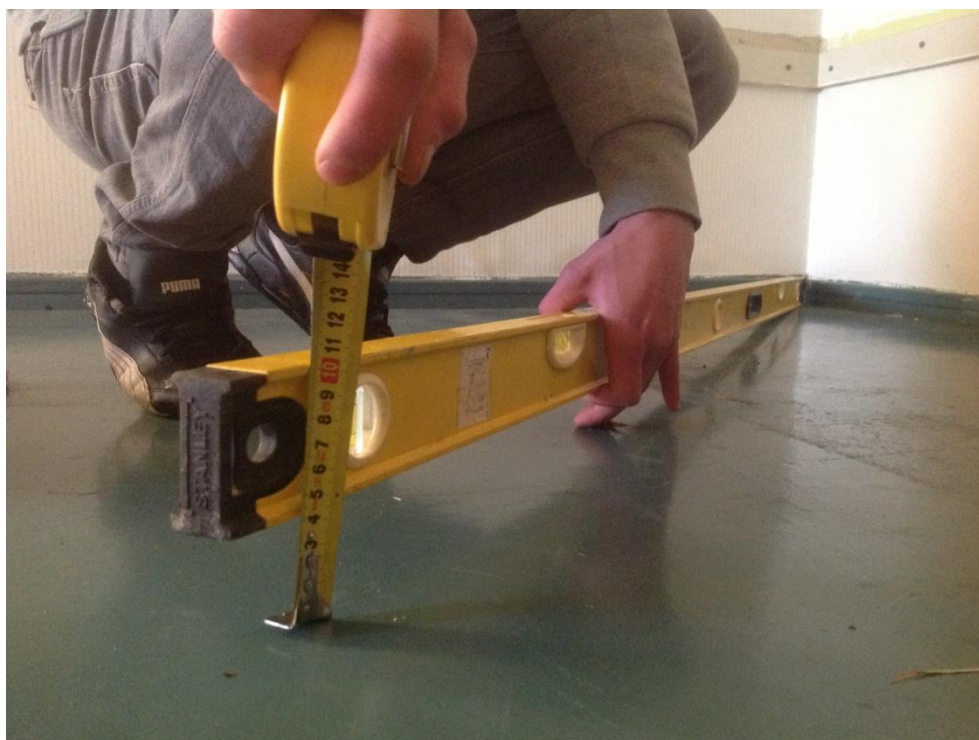
Kuva 9. Päärakennuksen olohuoneen lattia painunut voimakkaasti.
