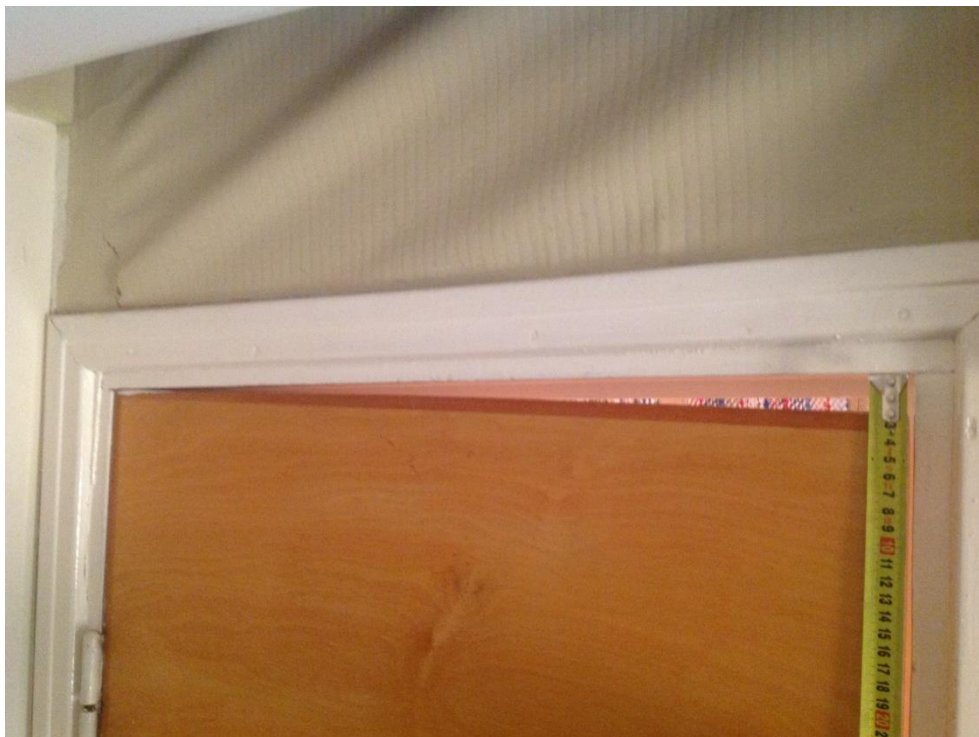
Kuva 15. Ovillehti raollaan karmista painumisesta johtuen.
