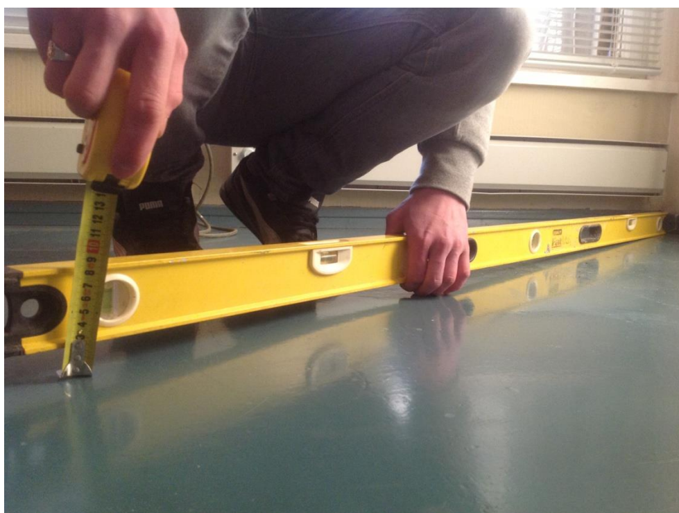
Kuva 10. Päärakennuksen olohuoneen lattia painunut voimakkaasti.
