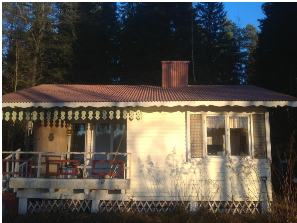
Kuva 7. Päärakennuksen vesikatto notkahtanut sivuilta kohti savupiippua.
