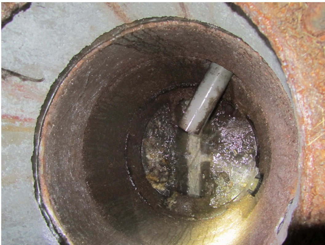
KUVA 15. Papinkadun kaivo, renkaiden saumoista ja tonttiliittymien ympäröivästä vuotava tarkistuskaivo (Henkilökohtainen tiedonanto 2013)
