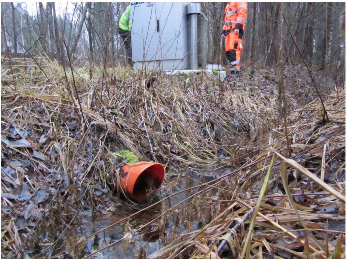
KUVA 12. Välikankaan jätevesipumppaamon ylivuotoputki, ojan vedenpinta ylivuotoputken tasossa. (Henkilökohtainen tiedonanto 2013)
