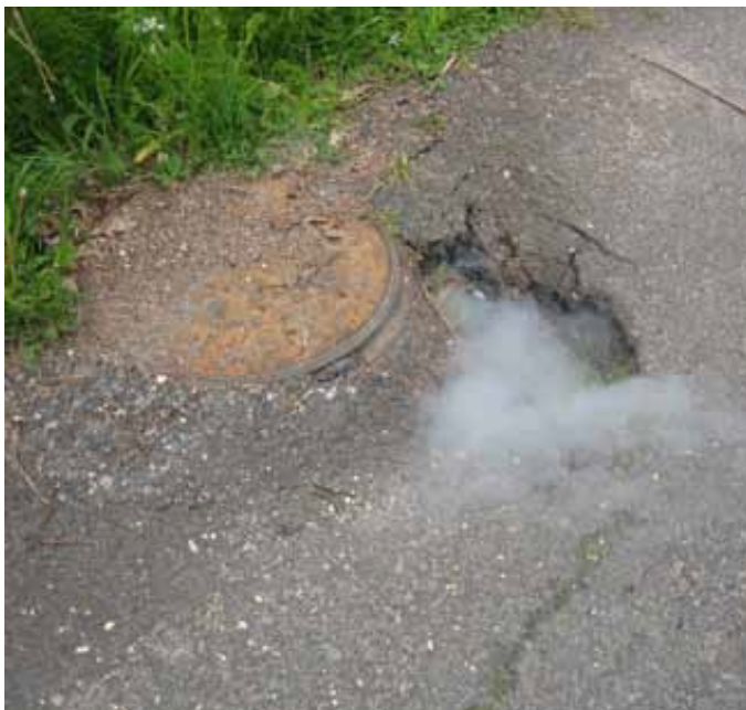
KUVA 7. Vuotava jätevesiviemärin tarkastuskaivo (Savukoe-esite, FCG)
