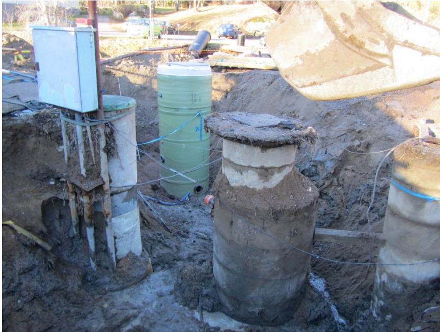
KUVA 4. KUUKANNIEMI 2 jätevesipumppaamon vaihtotyö, kuvan vasemmassa laidassa vanha ja uusi pumppaamo. (Henkilökohtainen tiedonanto, 2013)
