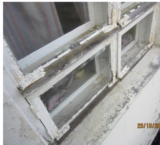
KUVA34. Ikkunoiden puuosat ovat kunnostuksen tarpeessa
