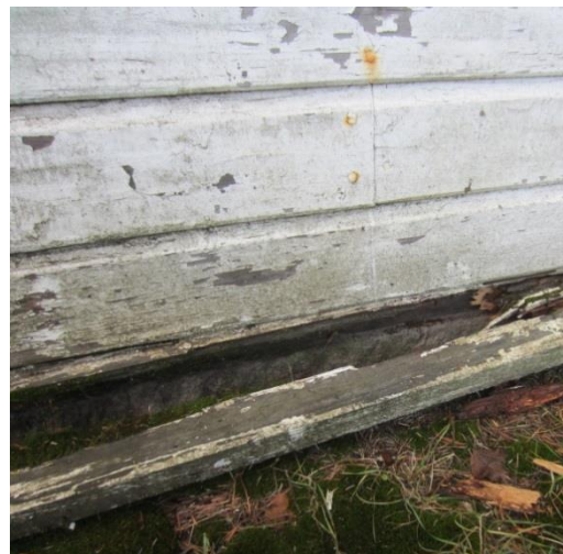
KUVA20. Alin hirsi on kastunut huonon tuuletuksen vuoksi
