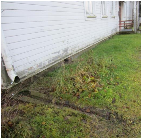
KUVA17. Alapohjan tuuletusraot ovat liian pienet talon etupuolella (kuva myös liitteessä 1)
