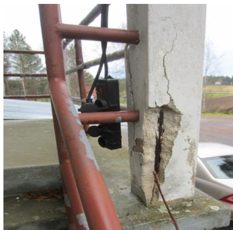
KUVA14. Betonipilari on huonossa kunnossa
