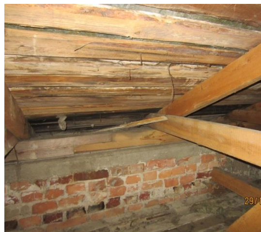
KUVA28. Aluslaudoitus on tummunut räystäiden kohdalta
