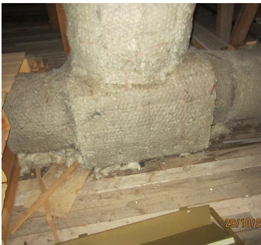
KUVA27. Ilmastointiputken eristeet ovat kastuneet
