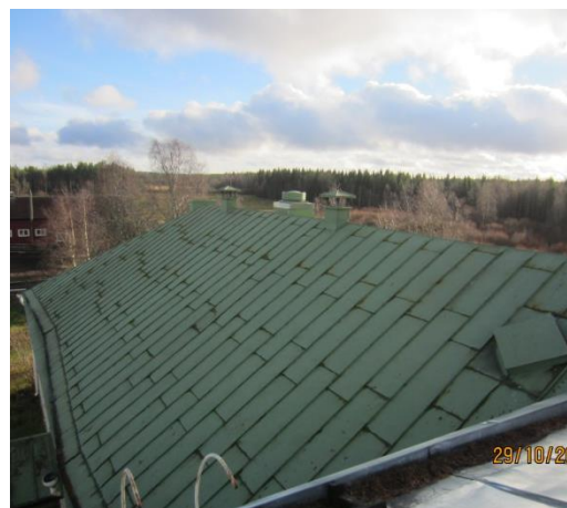
KUVA22. Vanhan osan peltikatto on korjauksen tarpeessa
