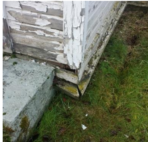
KUVA2. Nurmikko on liian lähellä rakennusta
