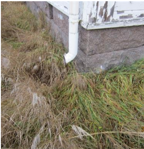
KUVA3. Syöksytyrven alta puuttuu rännikaivo
