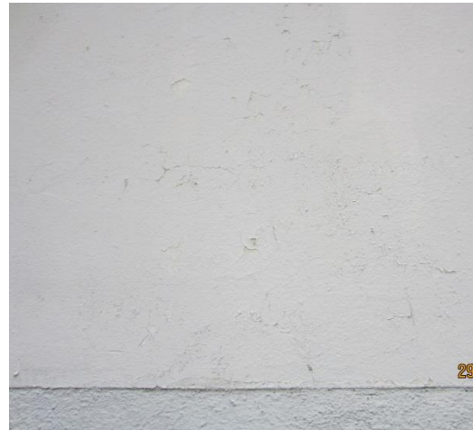
KUVA32. Rappaus hilseilee joissain kohti ulkoseinää
