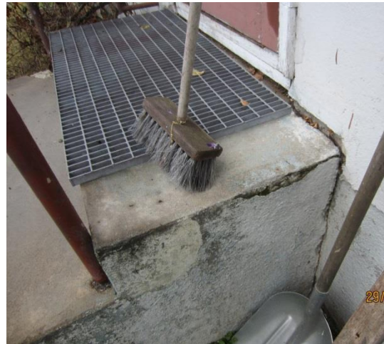
KUVA8. Ulkoseinän ja portaikon rajapinta on heikossa kunnossa
