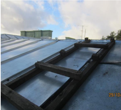
KUVA 23. Kattoturvatuotteet ovat heikossa kunnossa (kuva myös liitteessä 1)
