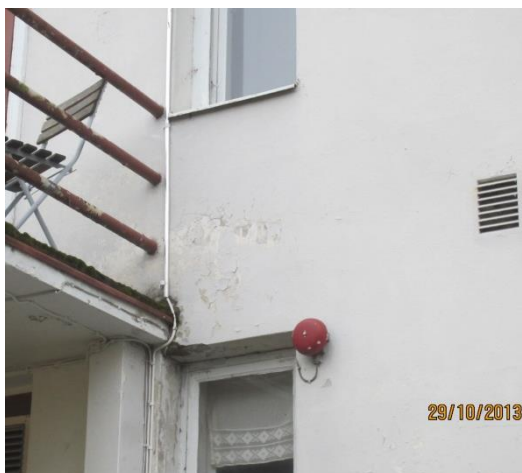
KUVA13. Parvekkeen ja seinän rajalle on kertynyt kosteutta
