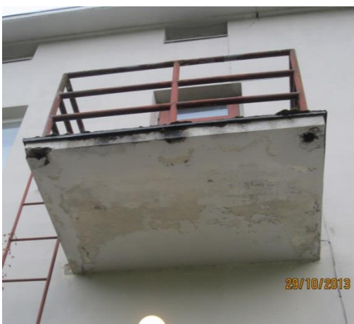
KUVA11. Ulokeparvekkeen alapuoli on huonossa kunnossa
