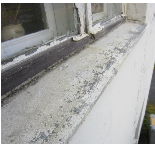
KUVA35. Vesipenkkipellillä ei ole riittävästi kallistusta ja se on heikossa kunnossa
