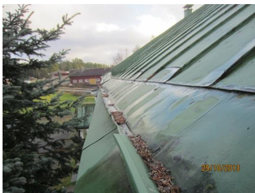
KUVA 4. Rakennuksessa on jalkarännit (kuva myös liitteessä 1)
