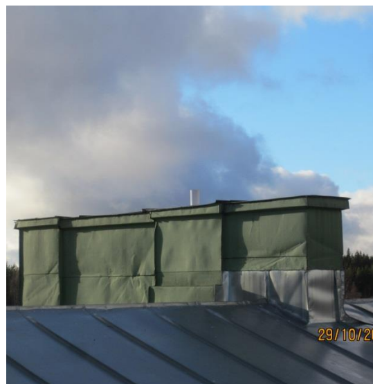
KUVA30. Savupiipun päältä uupuu piipunhattu
