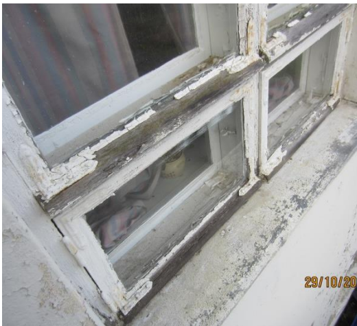
KUVA 34. Ikkunoiden puuosat ovat kunnostuksen tarpeessa (kuva myös liitteessä)
