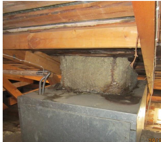
KUVA26. Aluslaudoitus on tummunut läpiviennin kohdalta
