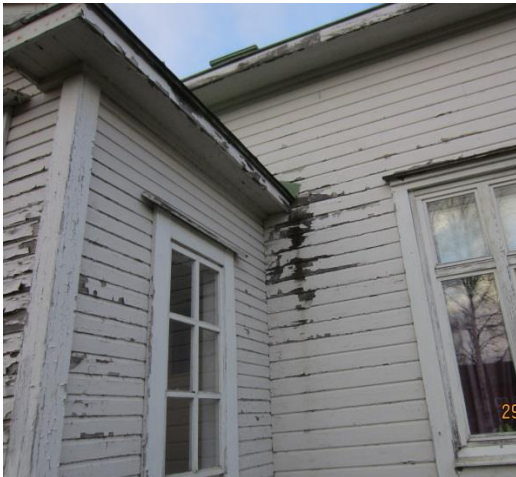
KUVA31. Puuverhouksessa paljon vaurioita
