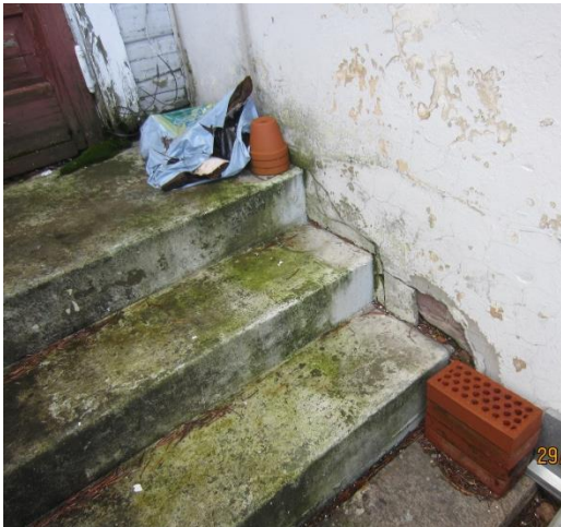
KUVA7. Ulkoseinän ja portaikon rajapinta on heikossa kunnossa
