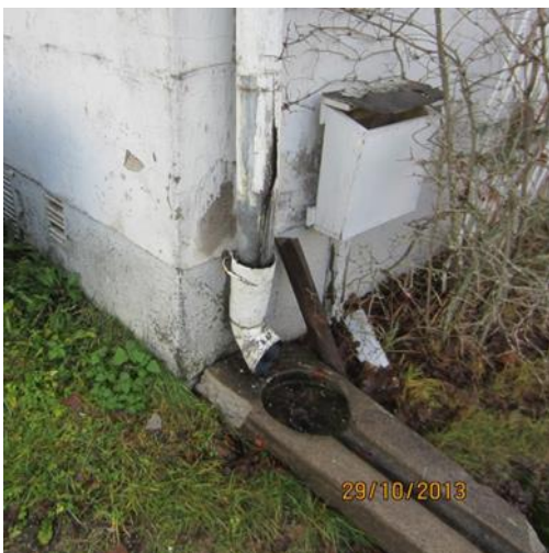
KUVA5. Syöksytyrvi on huonossa kunnossa
