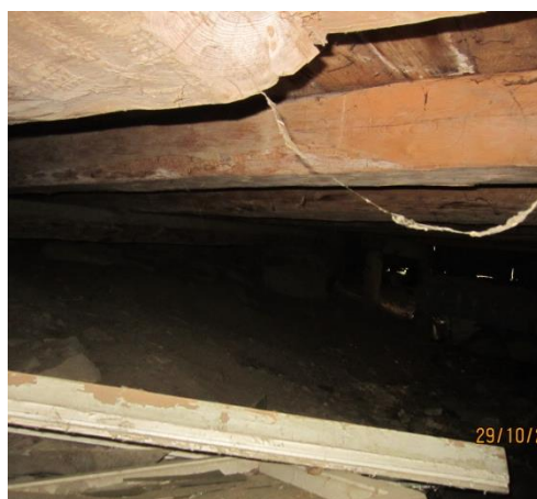
KUVA18. Maanpinnan korkeus vaihtelee alapohjassa liikaa, joka estää tuulettumisen
