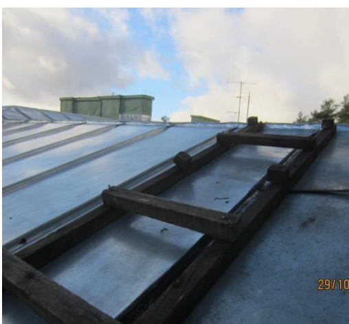
KUVA23. Kattoturvatuotteen heikossa kunnossa
