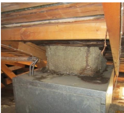
KUVA 26. Yläpohjan aluslaudoitus on tummunut läpiviennin kohdalta (kuva myös liitteessä 1)
