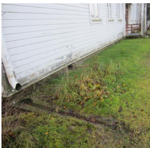
KUVA17. Alapohjan tuuletusraot ovat liian pienet
