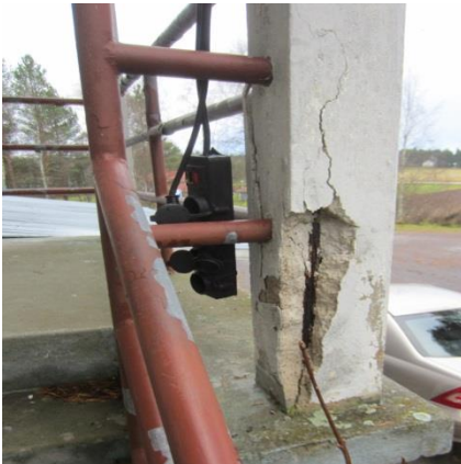
KUVA14. Betonipilari on huonossa kunnossa (kuva myös liitteessä 1)
