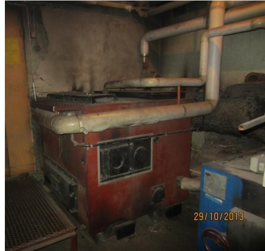
KUVA44. Lämmityslaitteen kannessa on vuotoa
