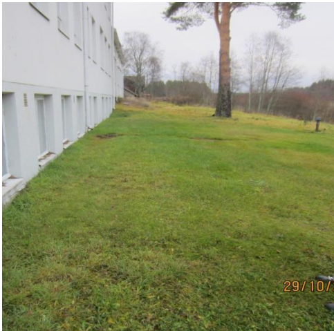
KUVA1. Puu on liian lähellä rakennusta
