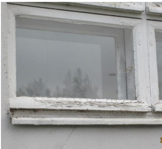
KUVA33. Ikkunoiden puuosat ovat kunnostuksen tarpeessa
