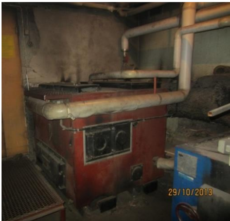
KUVA 44. Lämmityslaitteen kansi vuotaa (kuva myös liitteessä 1)
