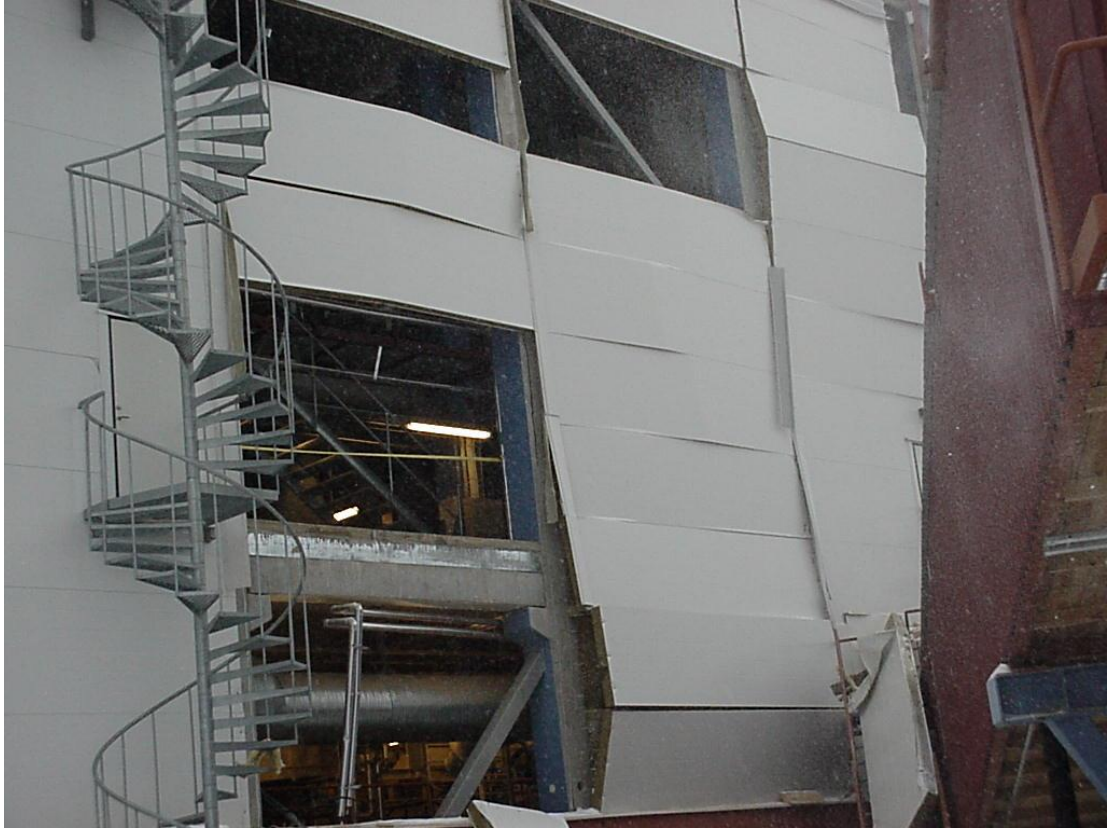
Kuva 12. Elementtirakenteinen Paroc-paineenpurkauseinä räjähdysten jälkeen.(Blow-out parts in a Paroc panel wall, 10)
