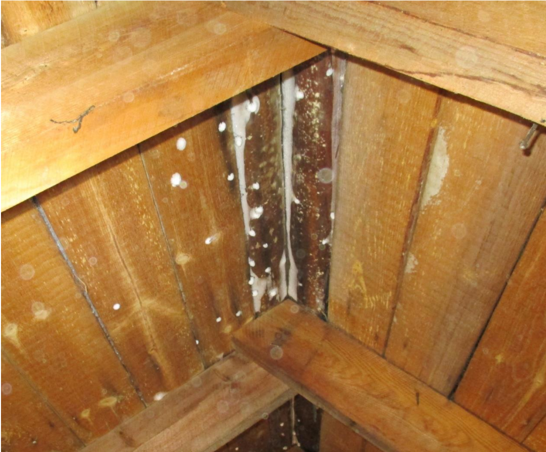
Kuva 11. Kosteuden kertymistä ja kuurautumista yläpohjassa. Kuva: Arttu Pitkänen, 2013
