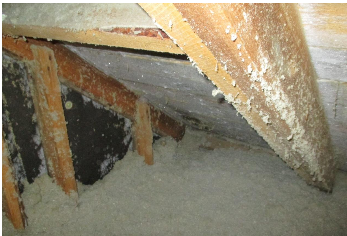
Kuva 10. Yläpohjan lappeiden tuuletusraot on tukittu. Kuva: Arttu Pitkänen, 2013
