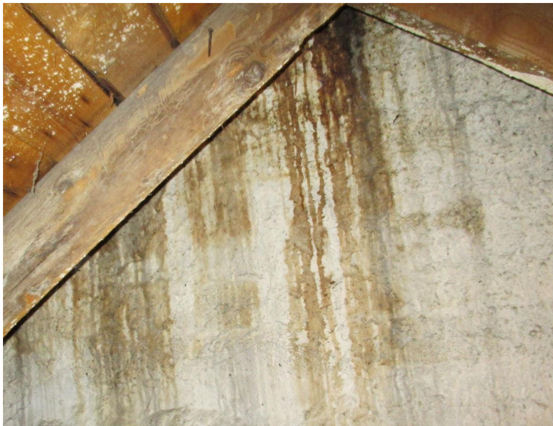
Kuva 12. Savupiipun läpivienti vesikatossa on vuotanut. Kuva: Arttu Pitkänen, 2013
