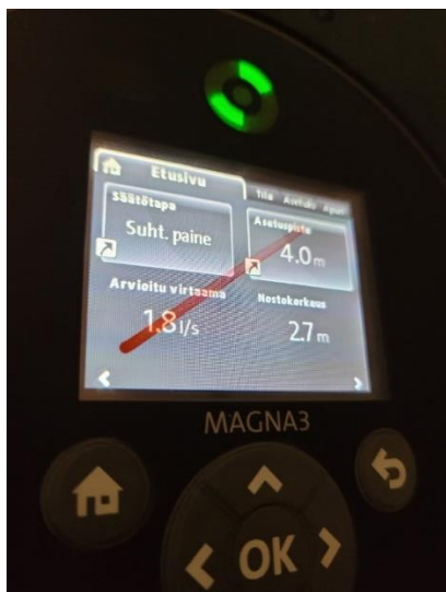
Kuva 12. Säädetty kiertovesipumppu. (Kuva: Visa Westerlund)
