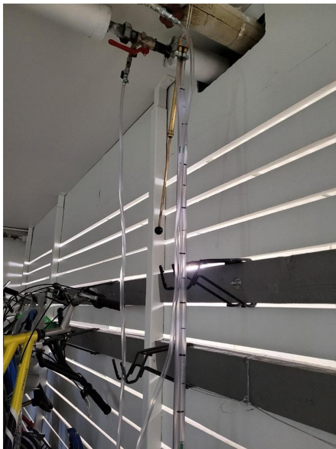
Kuva 13. linjasäätöventtiilin 12. Paine-eromittaus lastenvaunuvarastossa. (Kuva: Visa Westerlund)
