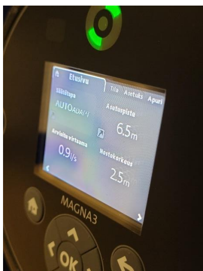
Kuva 22. Kiertovesipumpun lähtötilanne. (Kuva: Visa Westerlund)
