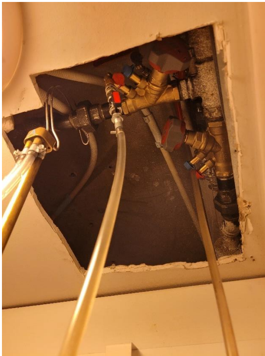
Kuva 19. linjasäätöventtiilit tuulikaapissa. (Kuva: Visa Westerlund)
