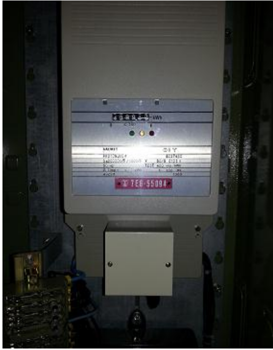
KUVA 3. Sähkön kokonaisenergian mittaus (sähköpäämittari)
