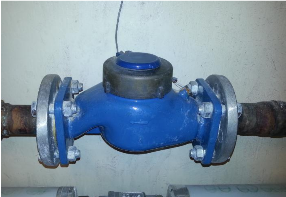
KUVA 4. Käyttöveden kokonaiskulutuksen mittaus (päävesimittari)
