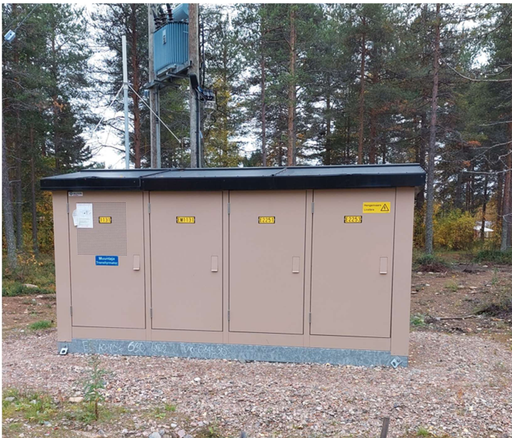
Kuva 11. Uusi puistomuuntamo ja kaukokäyttö erotinasema, sekä purkua odottava pylväsmuuntamo 2022
