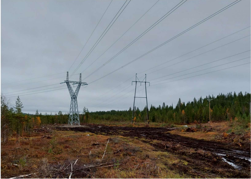
Kuva 7. Vasemmalla vpd-tuuliyhtiön oma linja ja oikealla KLS:n 110kV linja 2022
