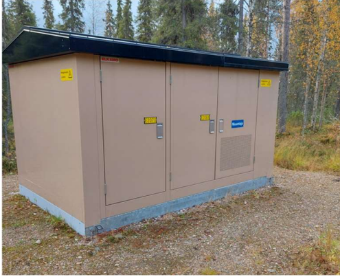
Kuva 8. Yhdistetty erotin- ja muuntamoasema 2022
