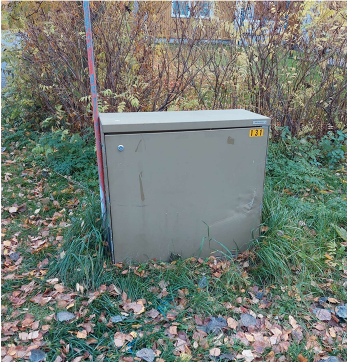
Kuva 10. JK131 Kemijärven keskustan alueen muuntopiirissä 2022
