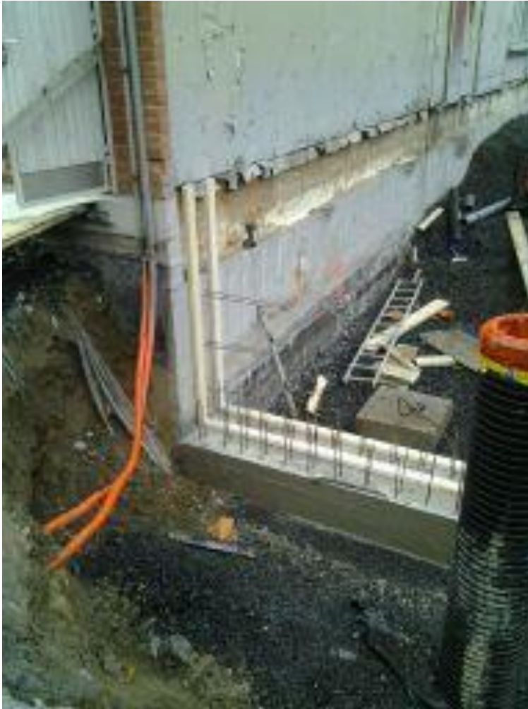
KUVA 7. Tartunnat anturasta ja vanhasta sokkelista perusmuuriin
