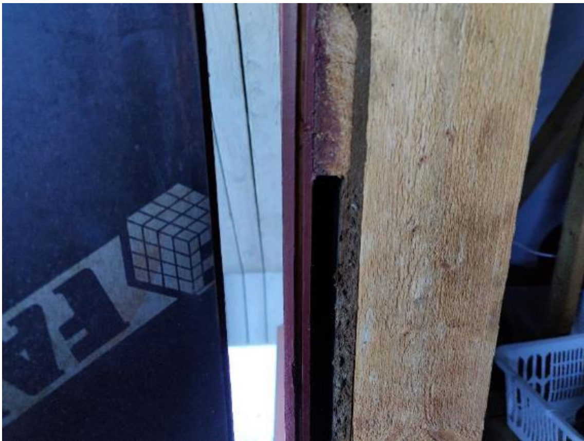
Kuva 16 Ulkoverhouksen ja tuulensuojalevyn välissä 20 mm tuuletusrako, oikeaoppinen rakenne olisi ulkoverhous, ristikoolaus, tuulensuoja ja runko
