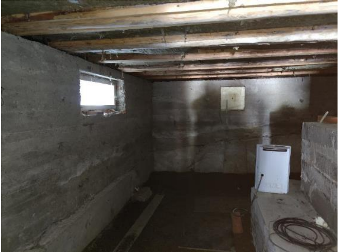
Kuva 13 Alapohjasta suositellaan poistettavan kaikki orgaaninen rakennusaines, kuten muottilaudat sekä ikkunoihin jätetyt puukiilat
