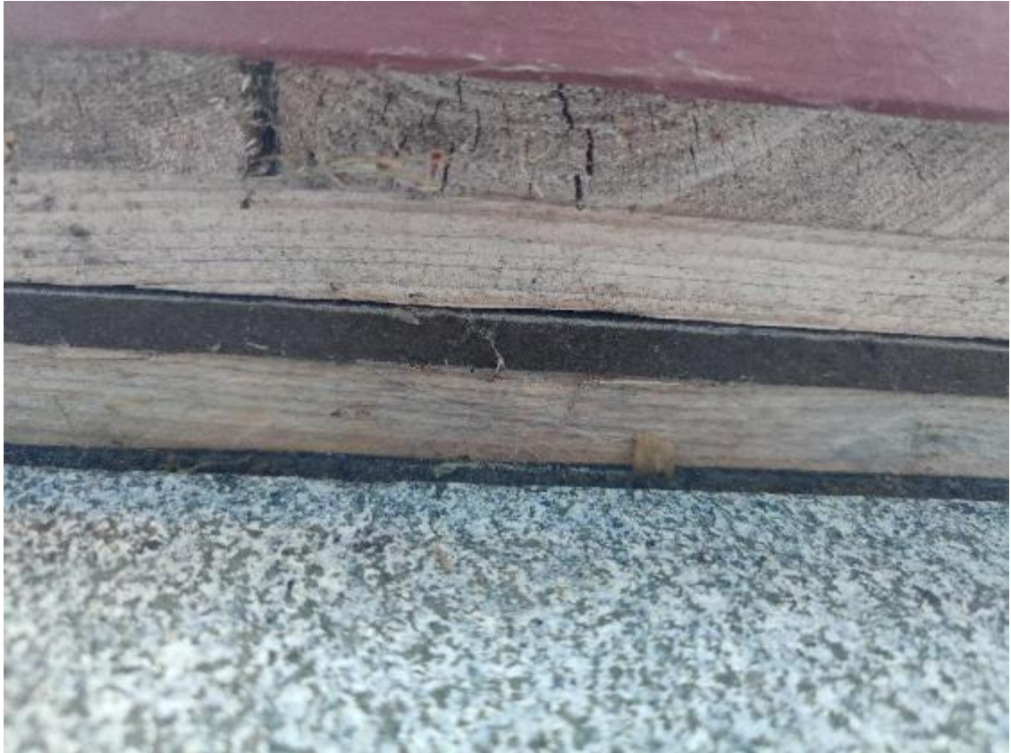
Kuva 17 Ulkoverhouksen alapäästä puuttuu tuuletusrako, rako tulisi olla vähintään 20 mm ja auki verhouksen yläreunaan asti
