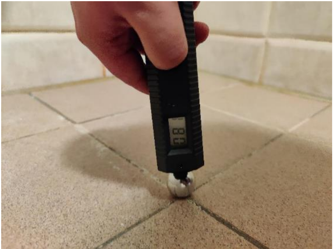
Kuva 29 Suihkun alta mitattiin kohonneita kosteuspitoisuuksia
