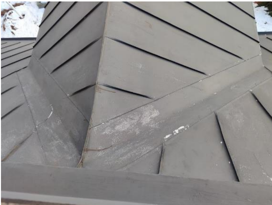
Kuva 22 Parvekkeen sekä päärakennuksen katon liitoksessa peltikatteen maali hilseillyt
