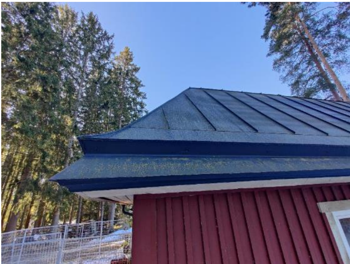
Kuva 26 Talousrakennuksen vesikatolla runsaasti sammalta
