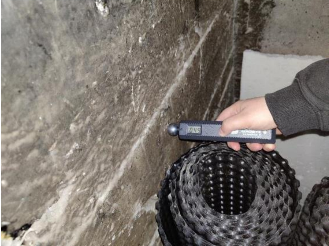
Kuva 2 Sokkelin pintakosteuden mittausta Gann Hydromette pintakosteudenosoittimella, huomiona pintakosteudenosoittimella mitatut tulokset ovat vain suuntaa antavia ja tuloksia tulkitessa tulee tuloksia tulkita tietyllä varauksella.
