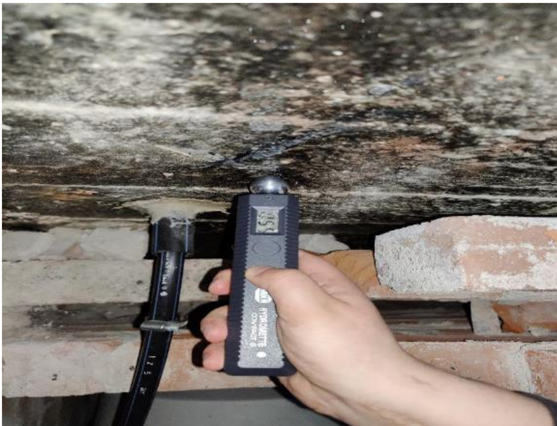
Kuva 11 Pintakosteudenosoittimella mitattu kellarin seinä, tulos on sama kuin kellarin sisäilman suhteellinen kosteus 55 RH% sisälämpötilan ollessa +7°C
