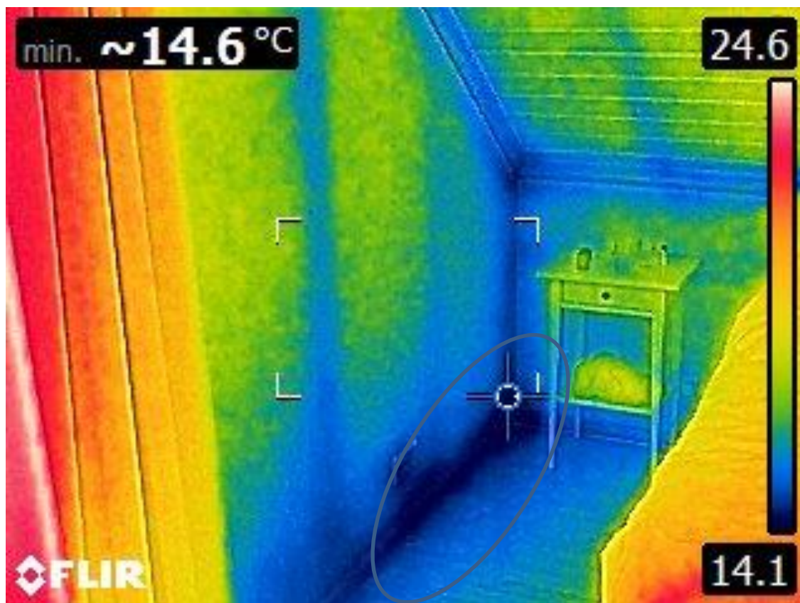
Kuva 30 Yläkerran ulkoseinissä havaittiin lämpökameralla lämpövuotoja
