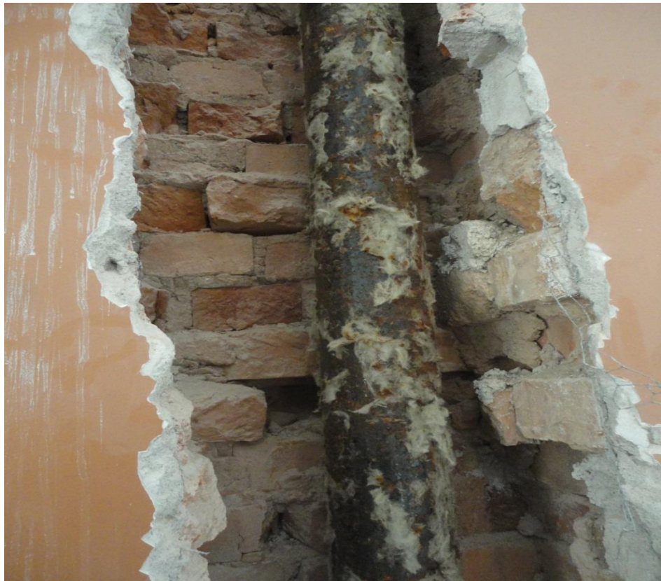
Kuva 11. Ulkoseinän sisällä kulkeva viemäriputki.
