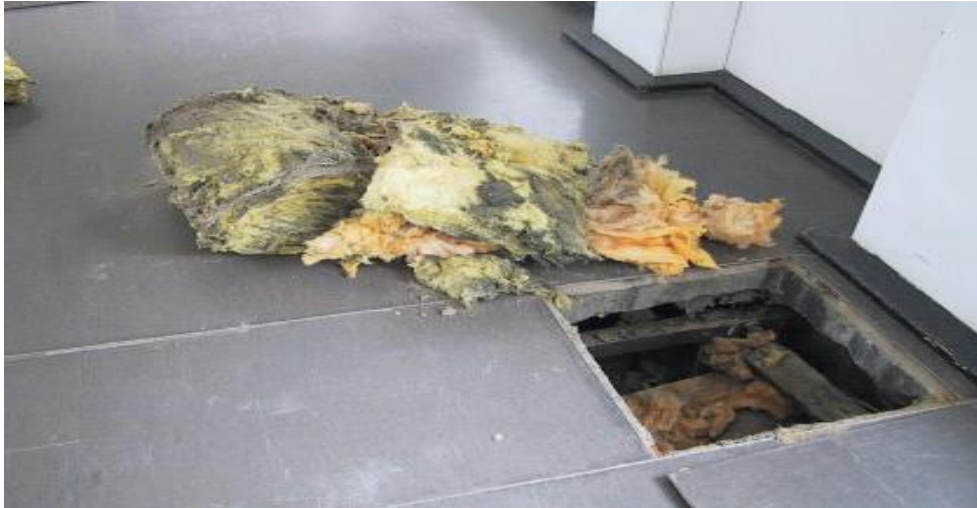
Kuva 14. Putkikanaalista poistettua mineraalivillajätettä. Teräksisen tarkastusluukun alapinta oli myös ruosteessa.
