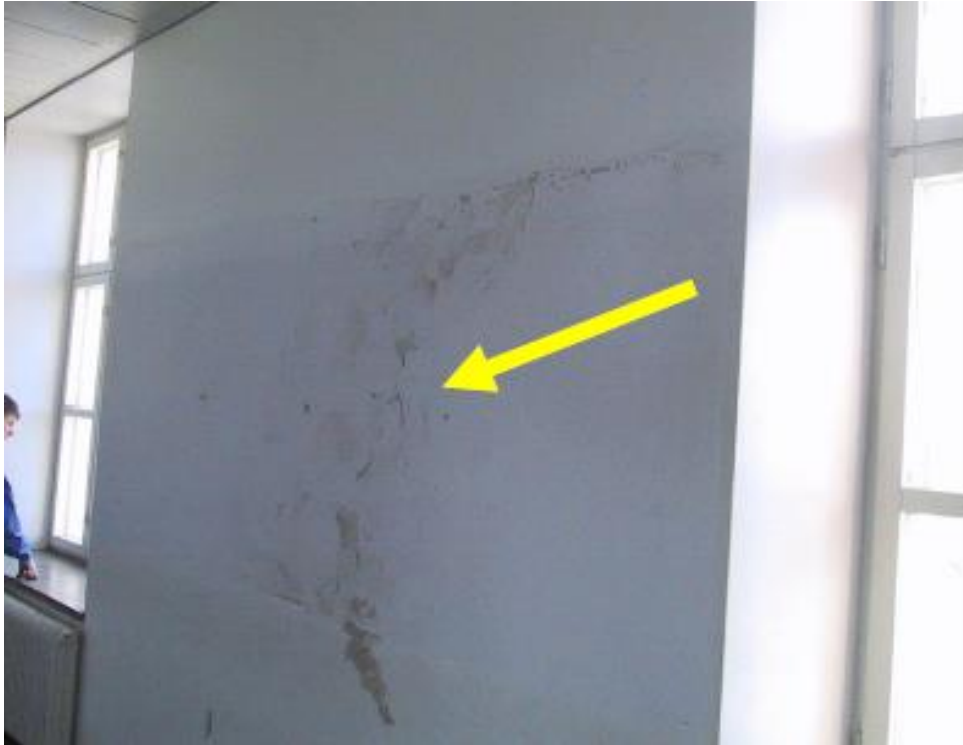
Kuva 12. Kattovesiviemäriin hormin vuotokohta ulkoseinässä.
