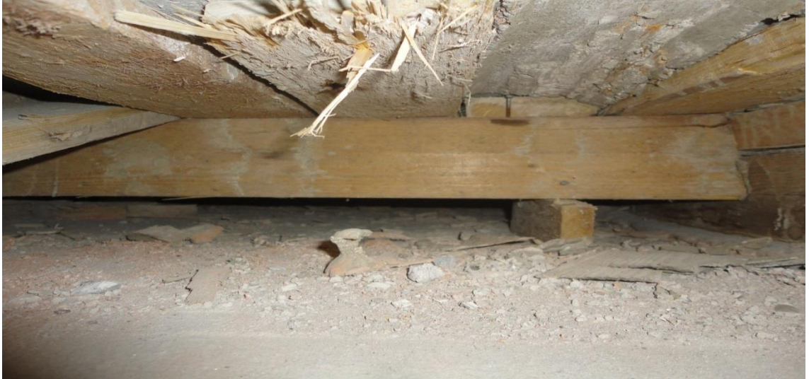
Kuva 20. Välipohjatilaan jätettyä muottilaudoitusta.
