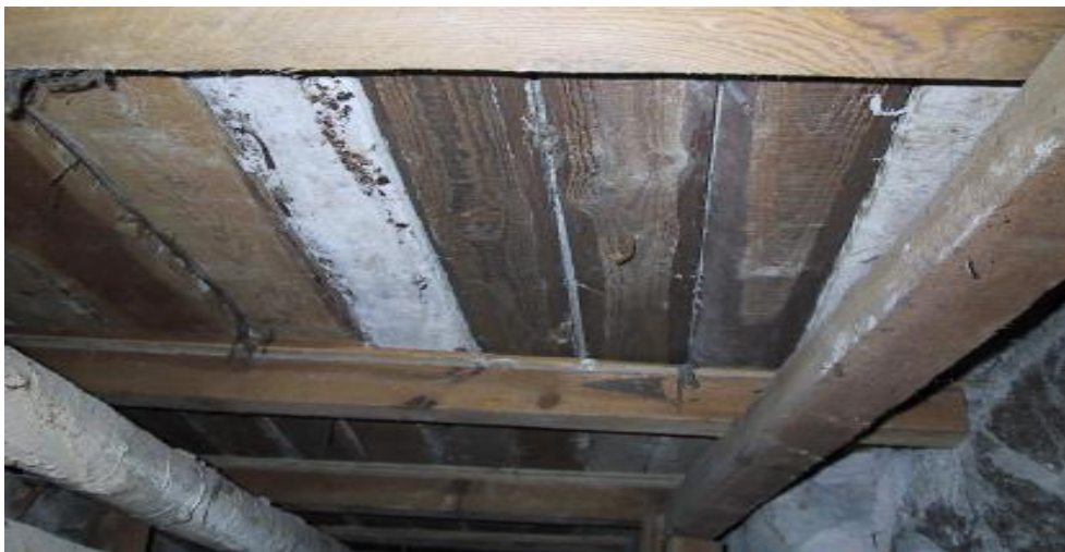
Kuva 15. Putkikanaalin kattoon jäänyttä muottilaudoitusta.
