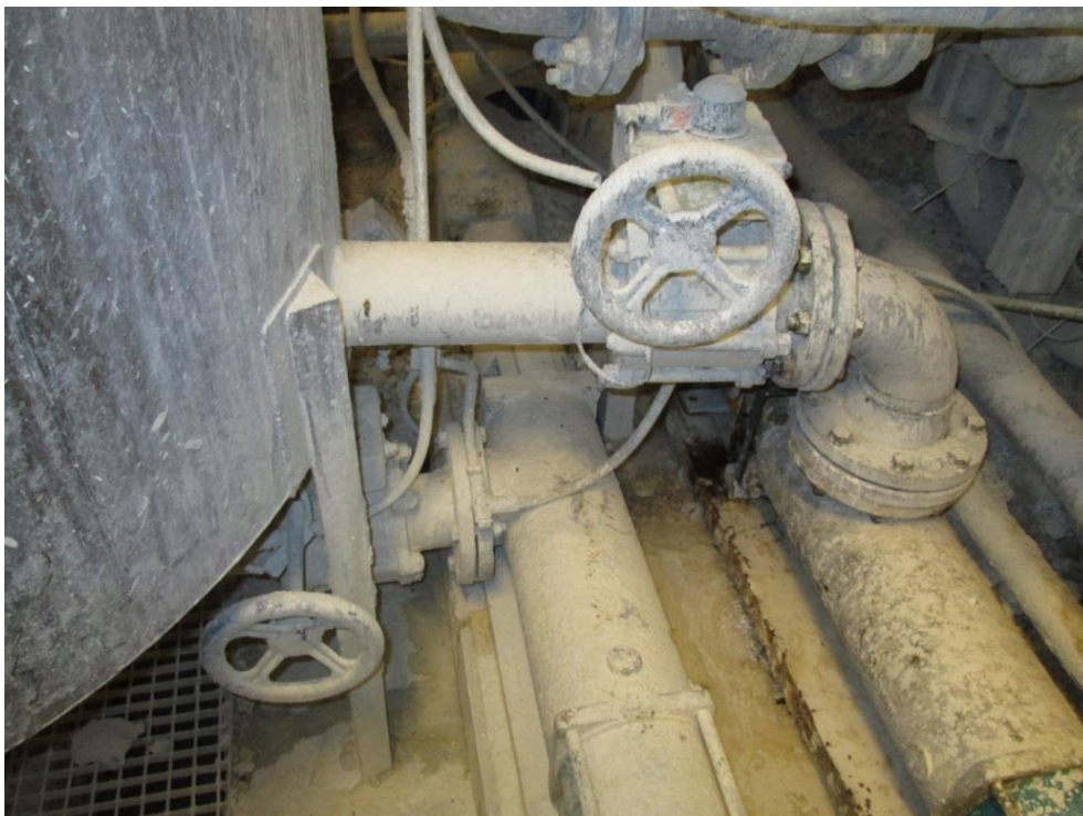
KUVA 12. Pastasäiliön nykyiset käsiventtiilit (Metsä Board Tako 1.4.2014)
