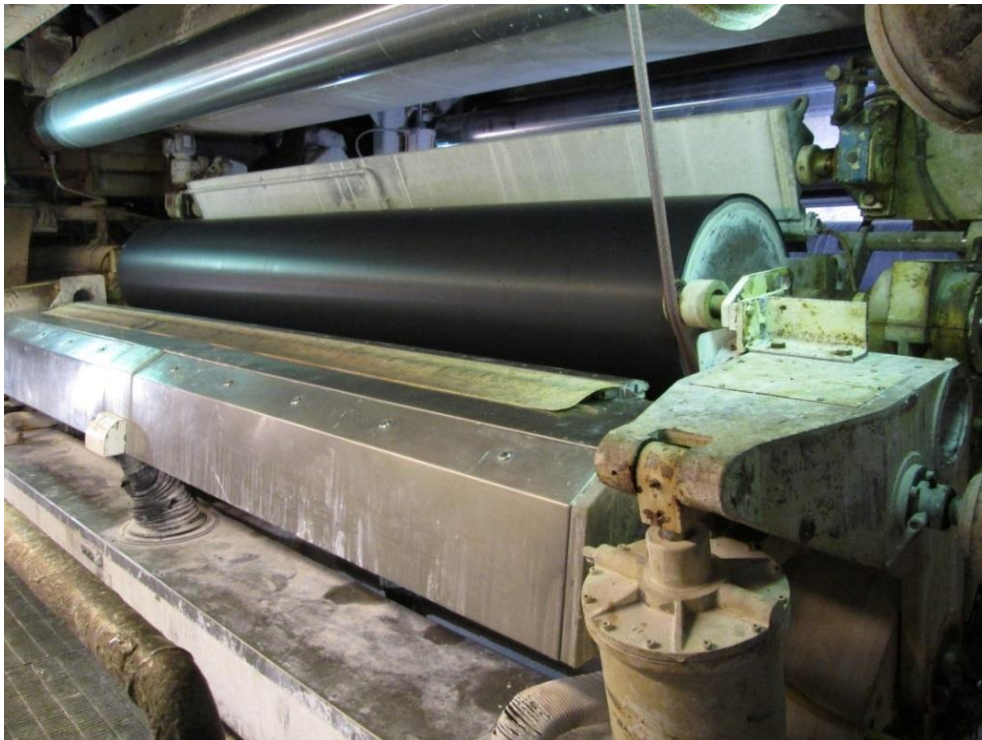
KUVA 11. 3. Päällystysasema pysähdyksissä, ei rainaa. (Metsä Board Tako 1.4.2014)
