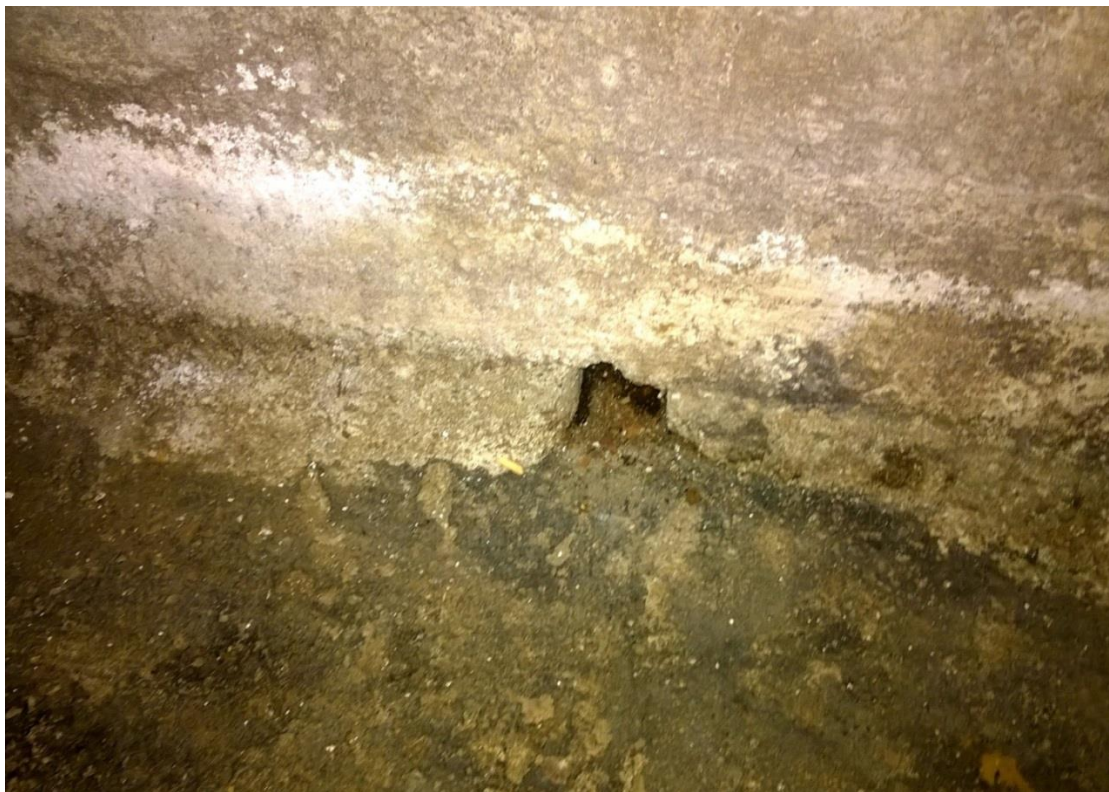
Kuva 14. Surritapin tukipuu lahonnut. (Kuva: Ville Taskinen)
