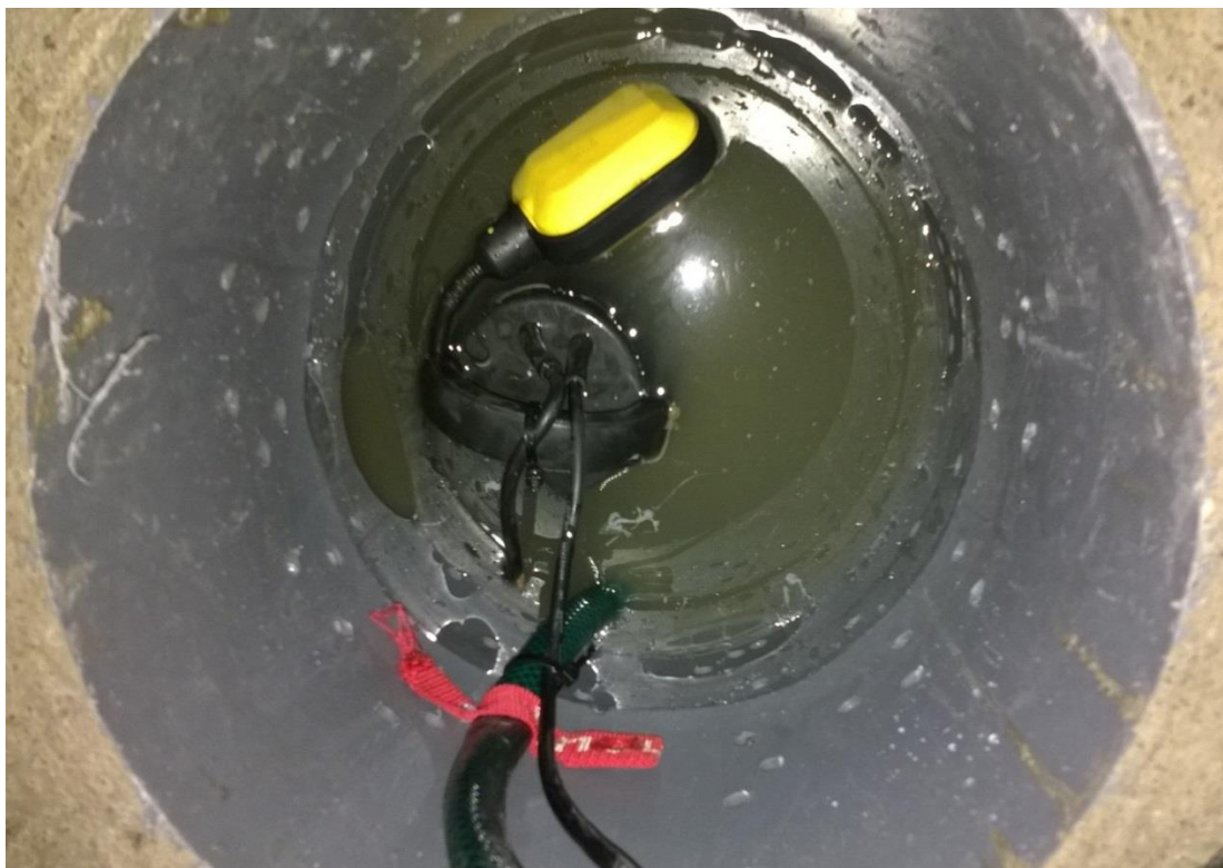
Kuva 18. Pumppu toiminnassa. (Kuva: Ville Taskinen)
