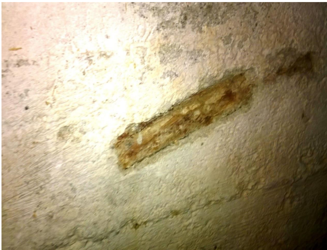
Kuva 15. Surritapin tukipuu lahonnut. (Kuva: Ville Taskinen)
