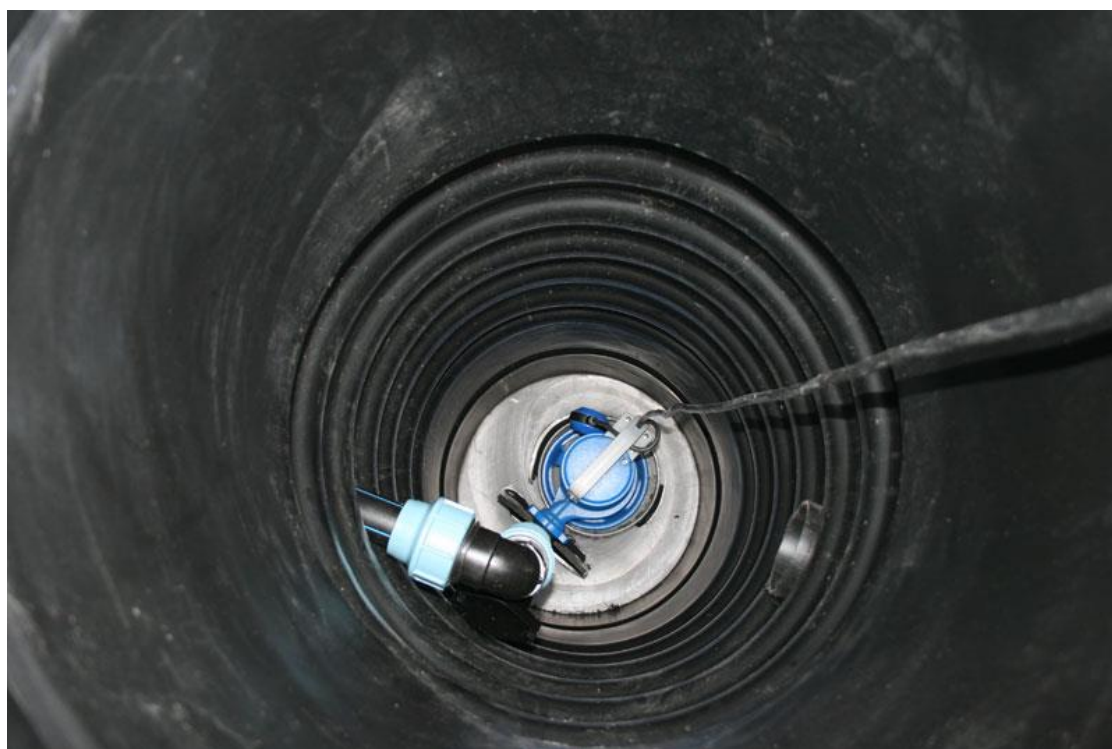
Kuva 2. Pienpumppaamo (Pumppaamot.fi b)
