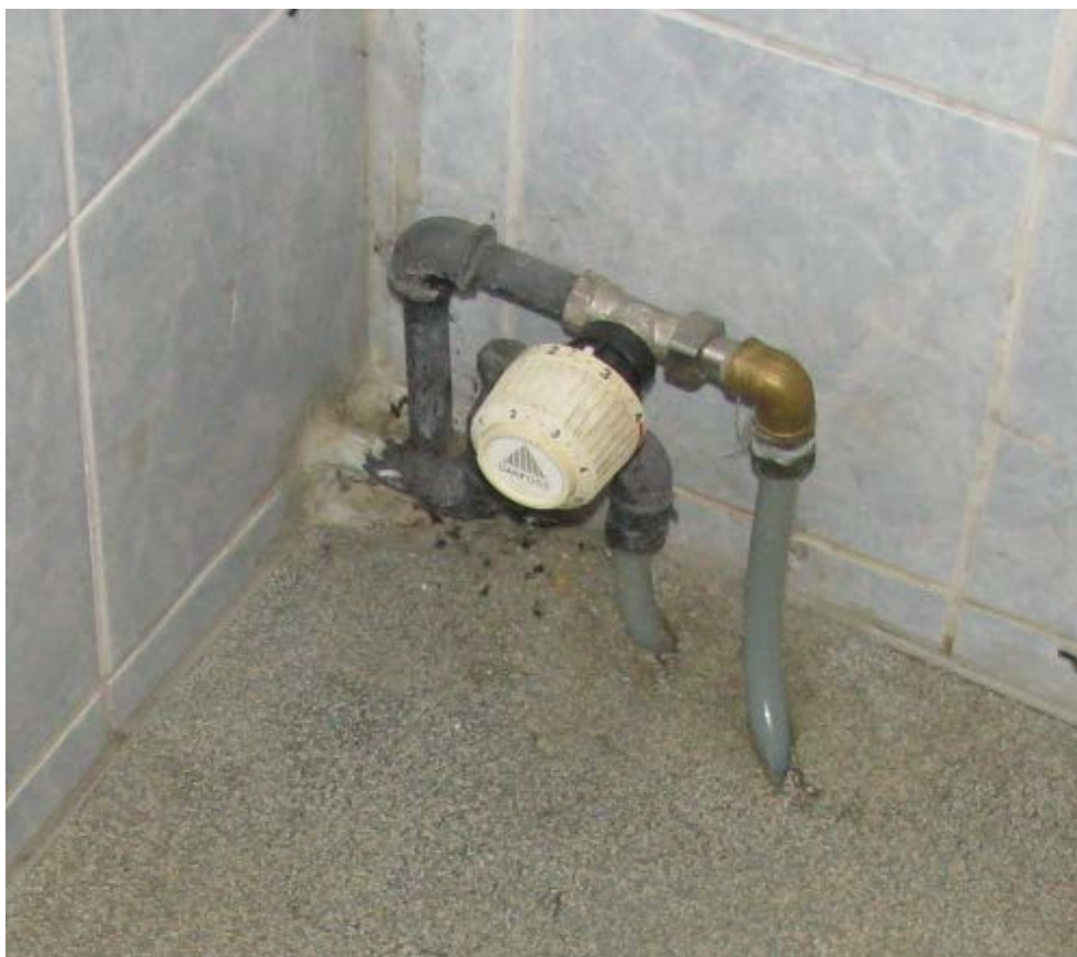
Kuva 14. Lattialämmitysputket nousevat suoraan suihkun lattiasta (Talja 2014-02-27)
