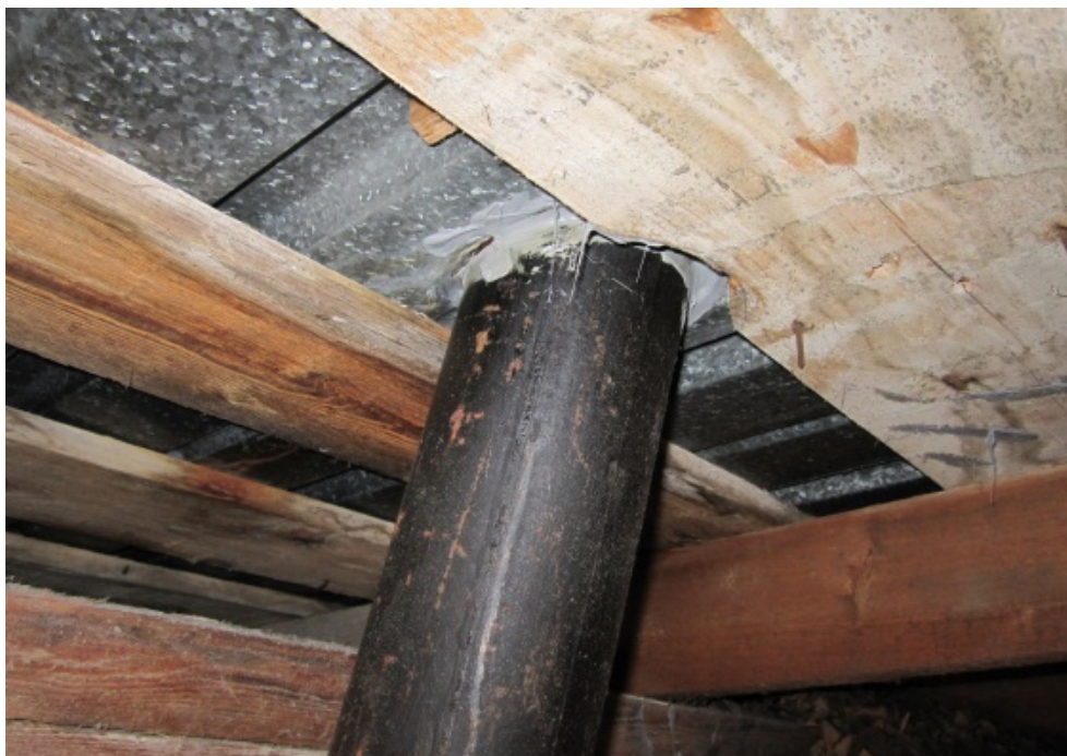
KUVA 2. Viemärin tuuletusputki ja puutteellinen läpiviennin tiivistys (Talja 2014-02-25)
