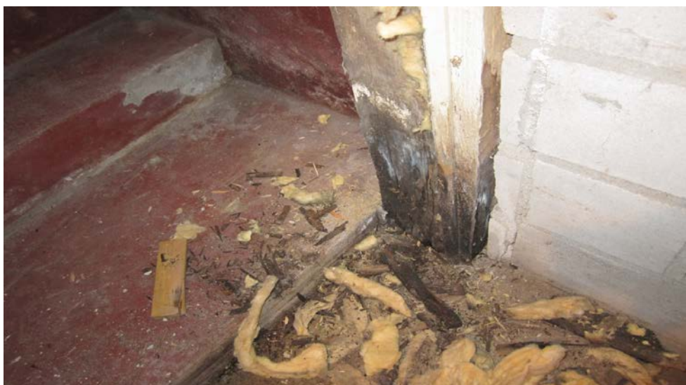
KUVA 8. Vaurioitunut oven puukarmi (Talja 2012-09-18)
