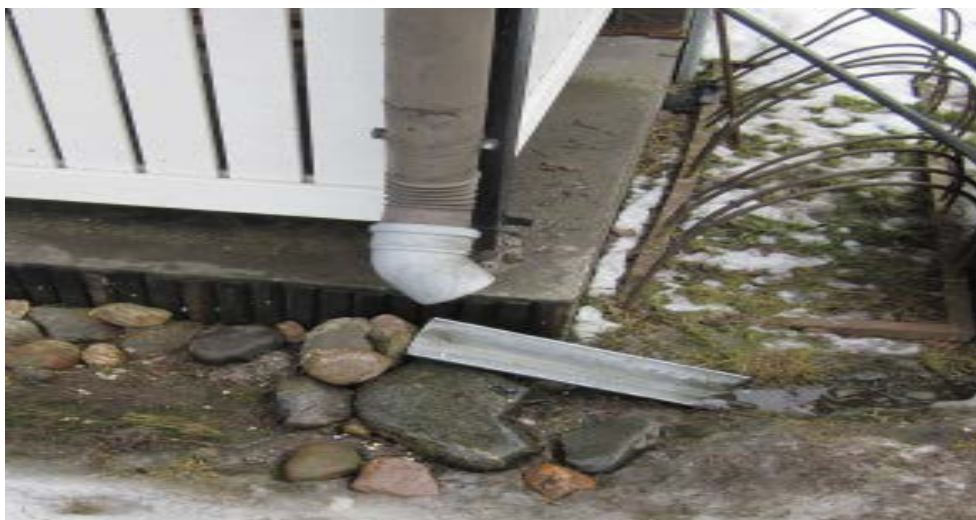
Kuva 9. Puutteellinen sadejärjestelmä (Talja 2014-02-25)
