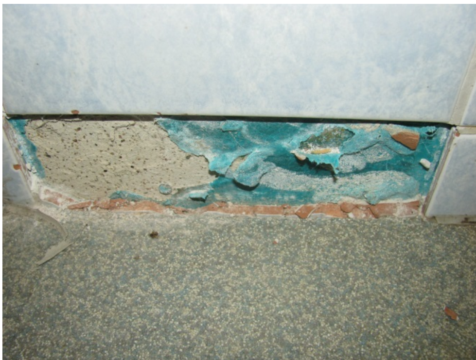
Kuva 13. Seinälaatoituksen rakennusvirhe (Talja 2012-08-22)
