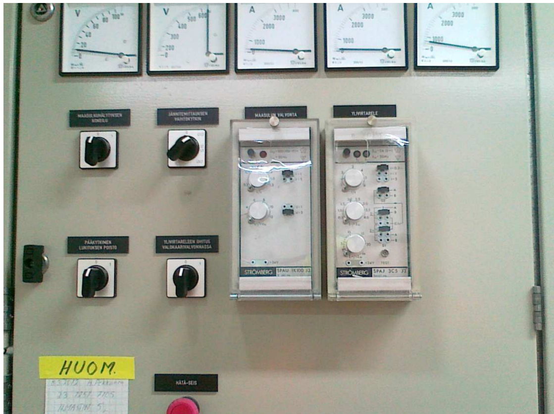
Kuva 9. ABB:n SPAJ/SPAU J -sarjan suojarkeitä (ylivirtarele ja maasulun valvontarele) asennettuna pääkeskukseen.
