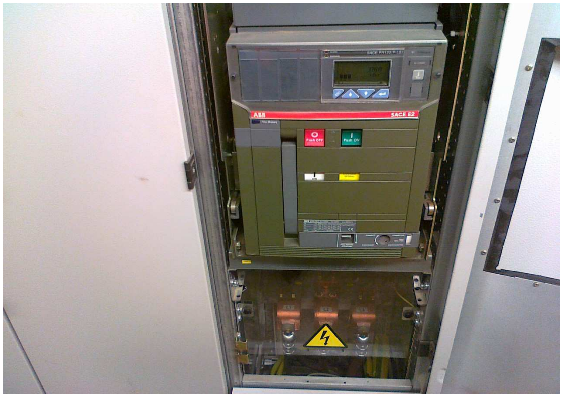
Kuva 6. ABB:n ilmakatkaisija asennettuna pääkeskukseen.
