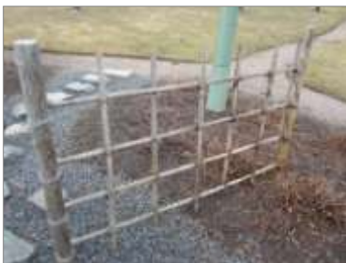
Kuva 35. Bambuaitoja joudutaan uusimaan säännöllisesti, koska ne mustuvat ja halkeilevat ajan kuluessa. (Tuominen 2014.)
