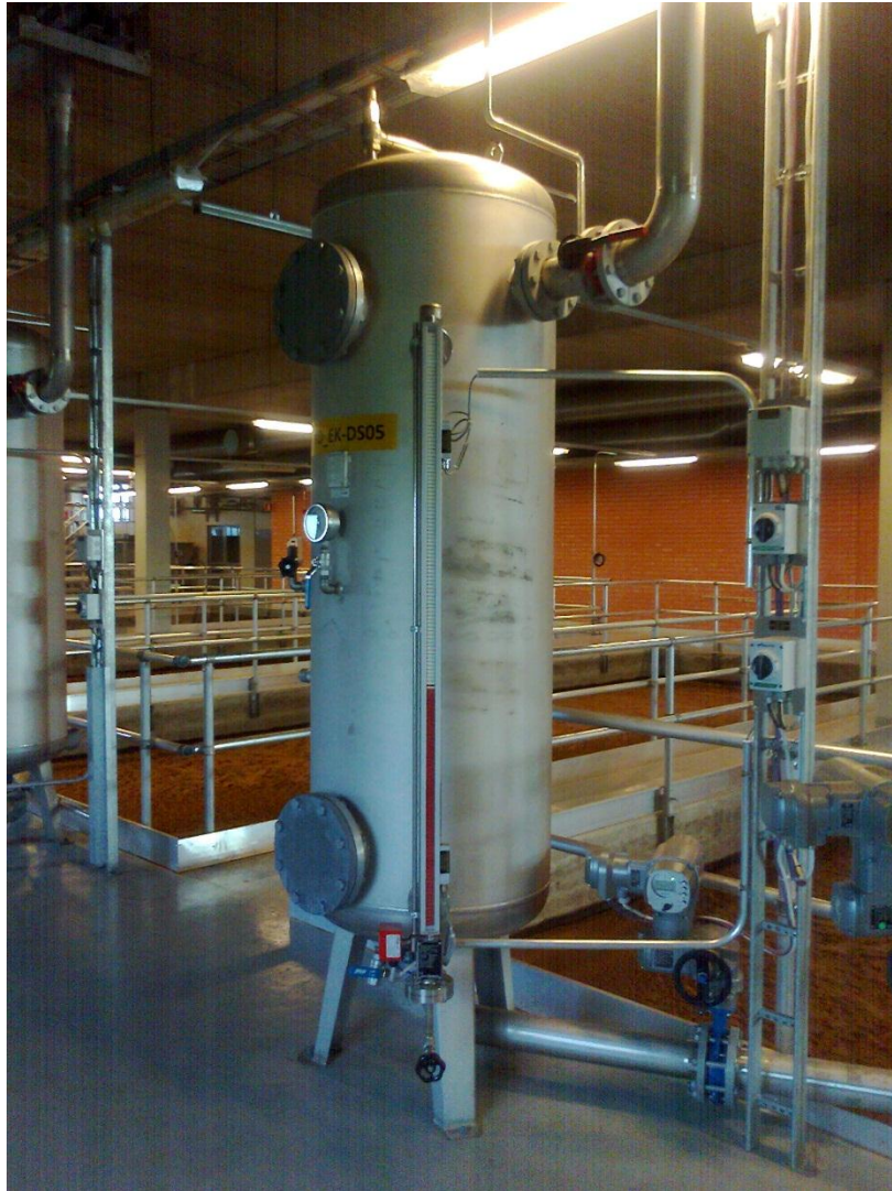
Kuva 11. Dispersioveden valmistamiseen käytetty saturaattori Turun seudun veden esikäsitteilylaitoksessa.
