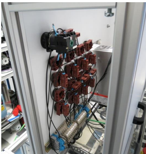
Kuva 15: Vaiheessa oleva oppimisympäristön ohjauksen johdotus.
