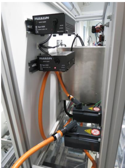
Kuva 14: Servomoottorit ovat sijoitettu oppimisympäristön alalaitaan.
