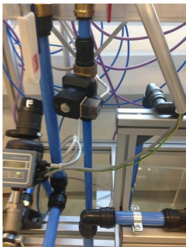
Kuva 5. Yläsäiliön laskuputken magneettiventtiili HV-5.
