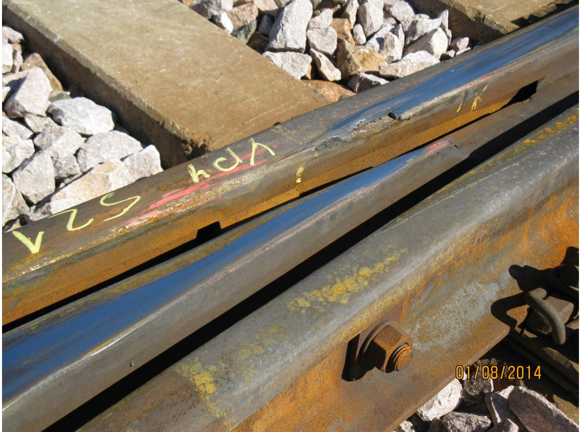
Kuva 4. Kuva liikenteen kuluttavuuden seurauksena vaurioituneesta vaihteen ristikosta. (Mäkitupa, Hirvaskari 2014)
