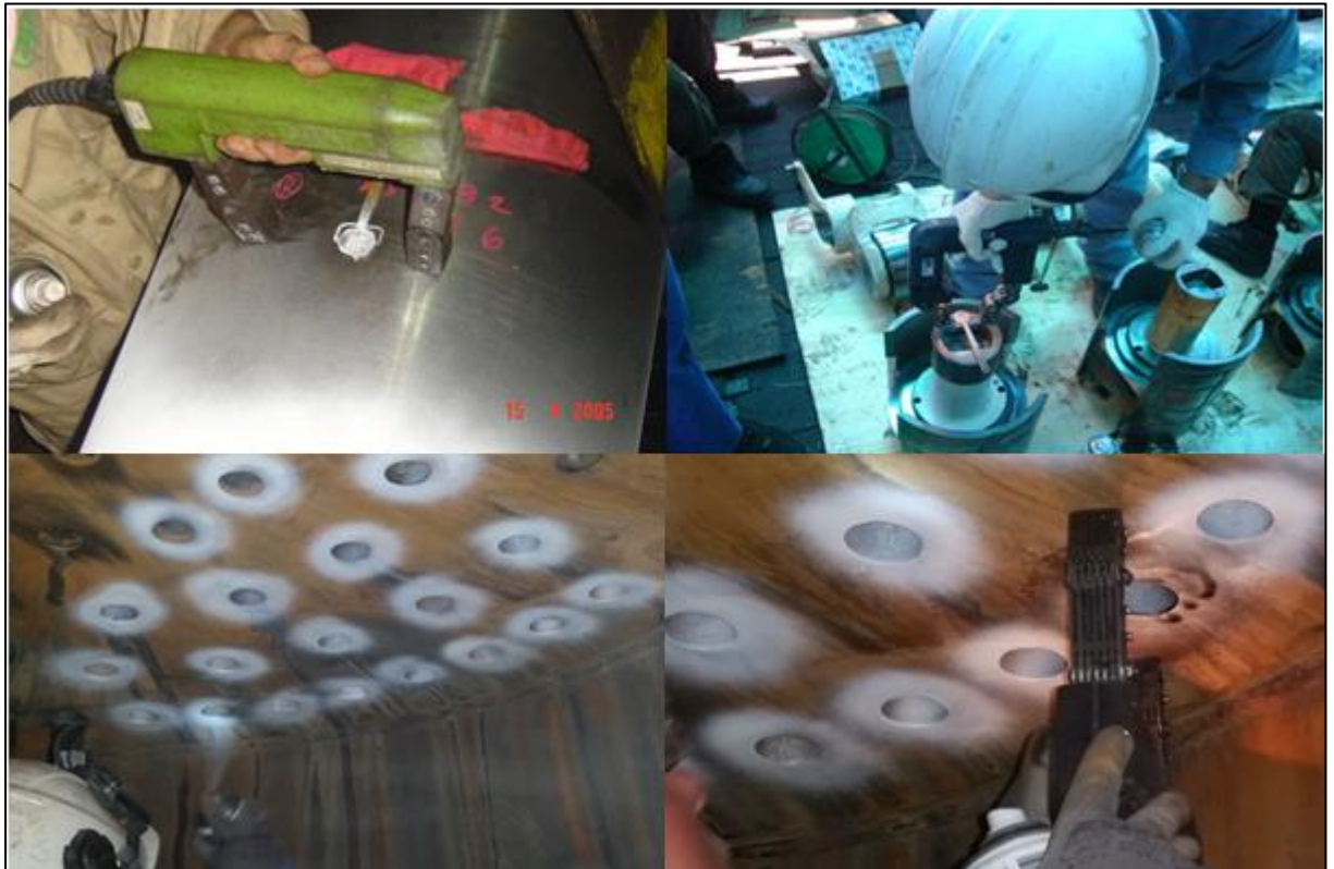
Kuva 43. Ylhäällä kaksi kuvaa erilaisten akselien tarkastuksesta, alhaalla kaksi kuvaa combi-kattilan palotilan putkien tarkastuksesta (18; 26).
