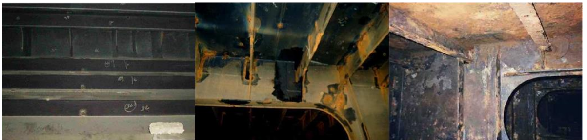
Kuva 12. Kuvia painolastitankkien tarkastuksista. Vasemmalla hyvässä kunnossa oleva tankki, keskellä kohtalaisessa kunnossa oleva tankki ja oikealla huonossa kunnossa oleva tankki. (18.)
