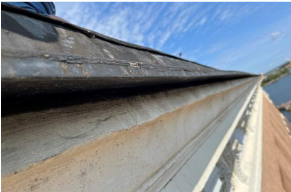
Kuva 19. Räystään korvausilma aukko tukossa, myrskypeltti puuttuu, eikä räystääspelttiä ole tuotu tuuletusaukon päälle tarpeeksi. Tällaisessa tilanteessa yläpohjan tuuletus ei toimi ja on vaarana, että vesi pääsee kulkeutumaan räystääspellin alta yläpohjaan (Innocate Oy).
