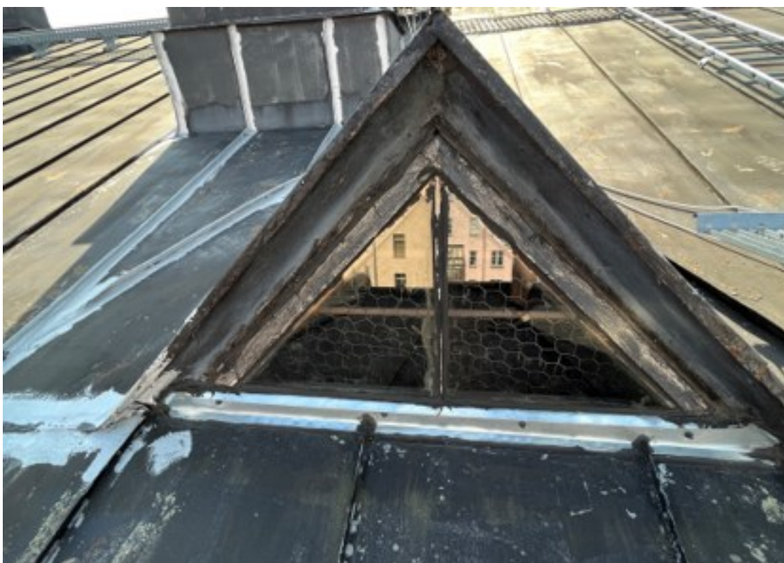
Kuva 20. Kattolyhteen rintataite on todella matala sekä läpivientien ympärillä tehty tiivistyksiä (Innocate Oy).
