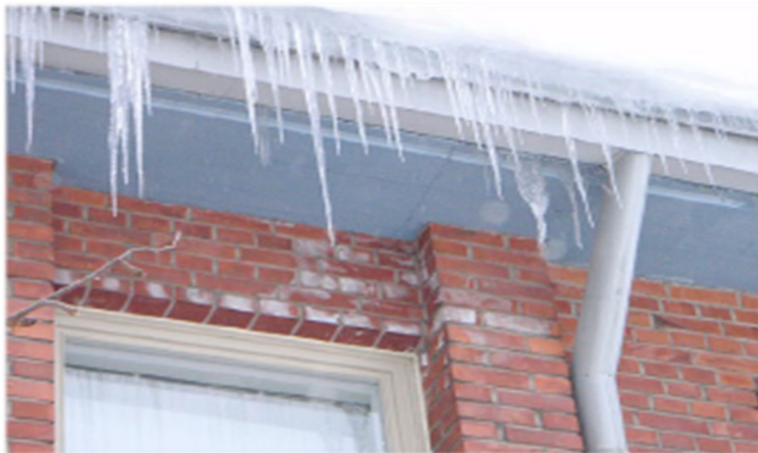
Kuva 27. Yläpohjan lämpövuotojen ja huonon tuuletuksen sulattamat lumet jäätyvät räystäälle muodostaen jääpuikkoja (Holmström, ym. 2016).
