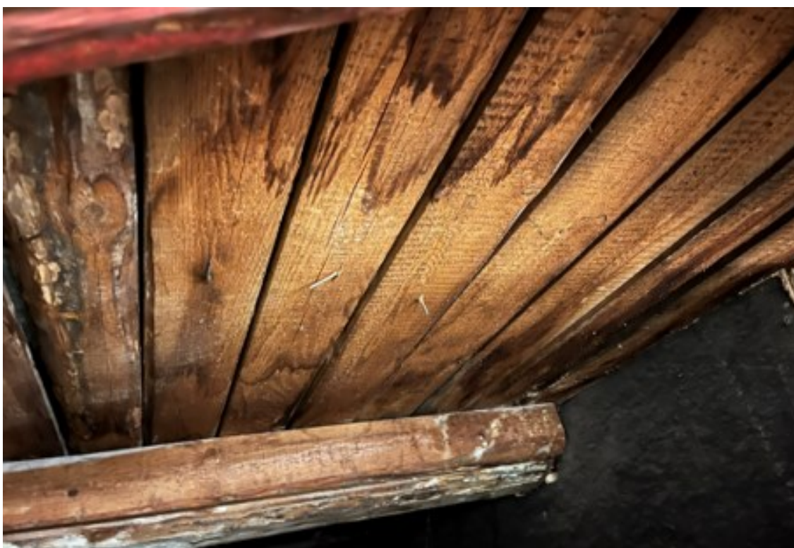
Kuva 22. Vesikaton alus- sekä kantavissa rakenteissa kosteuden aiheuttamia jälkiä. Jäljet syntyvät muun muassa pellin alapintaa kondensoituvasta ja saumojen sekä läpivientien epätiivelyskohtien läpi pääsevästä vedestä (Innocate Oy).
