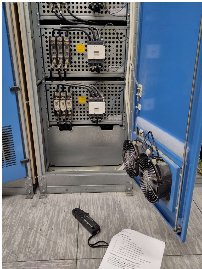
Kuva 38 Kondensaattoreiden mittaus pihtiampeerimittarilla.
