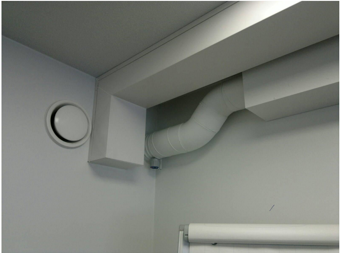
Kuva 13. Tuloputken ja poistoputken läpivienti
