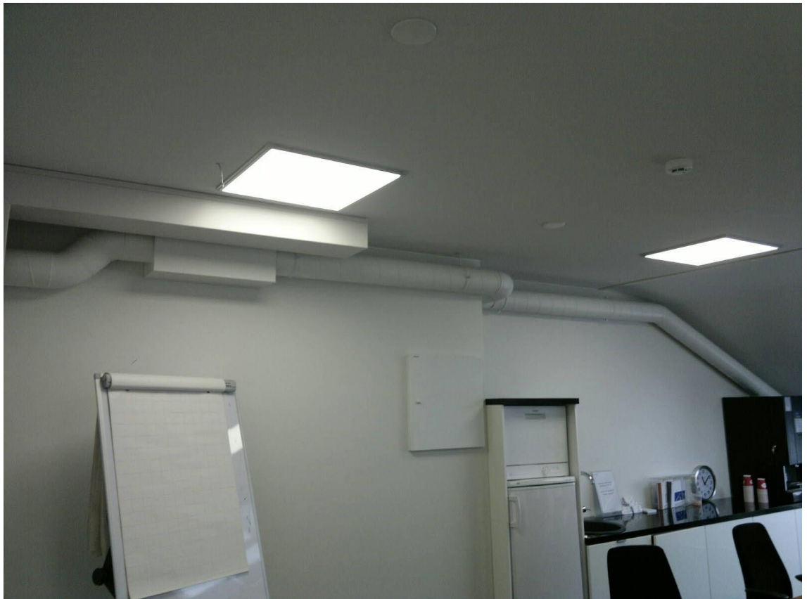
Kuva 7. Neuvotteluhuoneen ilmastoinnin nykyinen kanavointi ja äänenvaimennin
