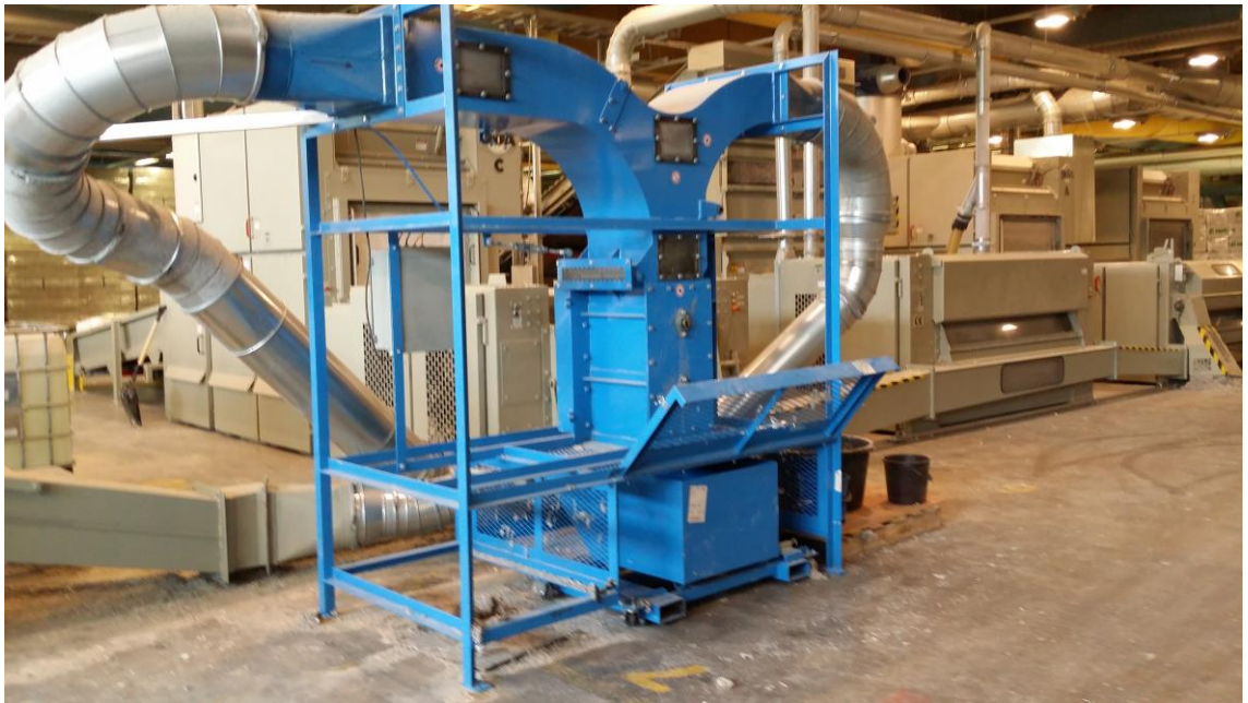
Kuva 3. Metallinerotin ja murskaimet
