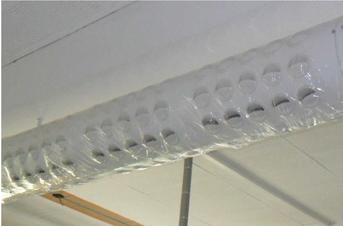
Kuva 10. Ilmanvaihdon päätelaite huolellisesti suojattuna.
